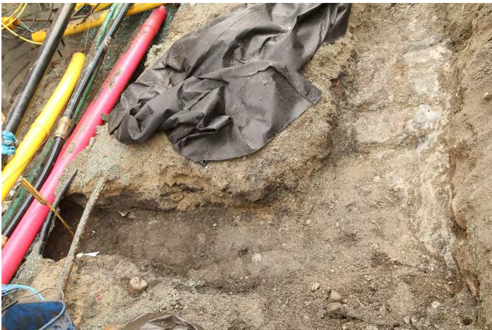
Figur 22: Oversiktsbilde: Kabeltrasè i den nordre delen av sjakt 3. Bilde tatt mot øst. Da_62848_123.
