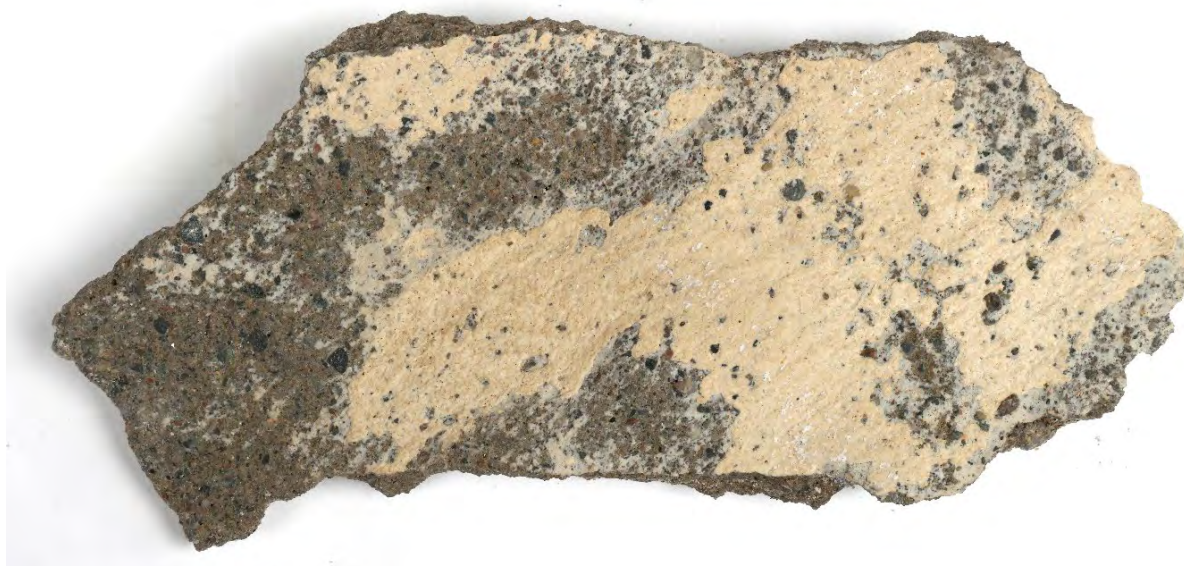
Fig. 23. Prøve på den harde sementholdige pussen som ble brukt i 1956. Mål: 11 x 7 cm. Pussen er dekket med to lag mineralittmaling og et ytre lag med kalkhvitning som er nesten helt vasket bort.
