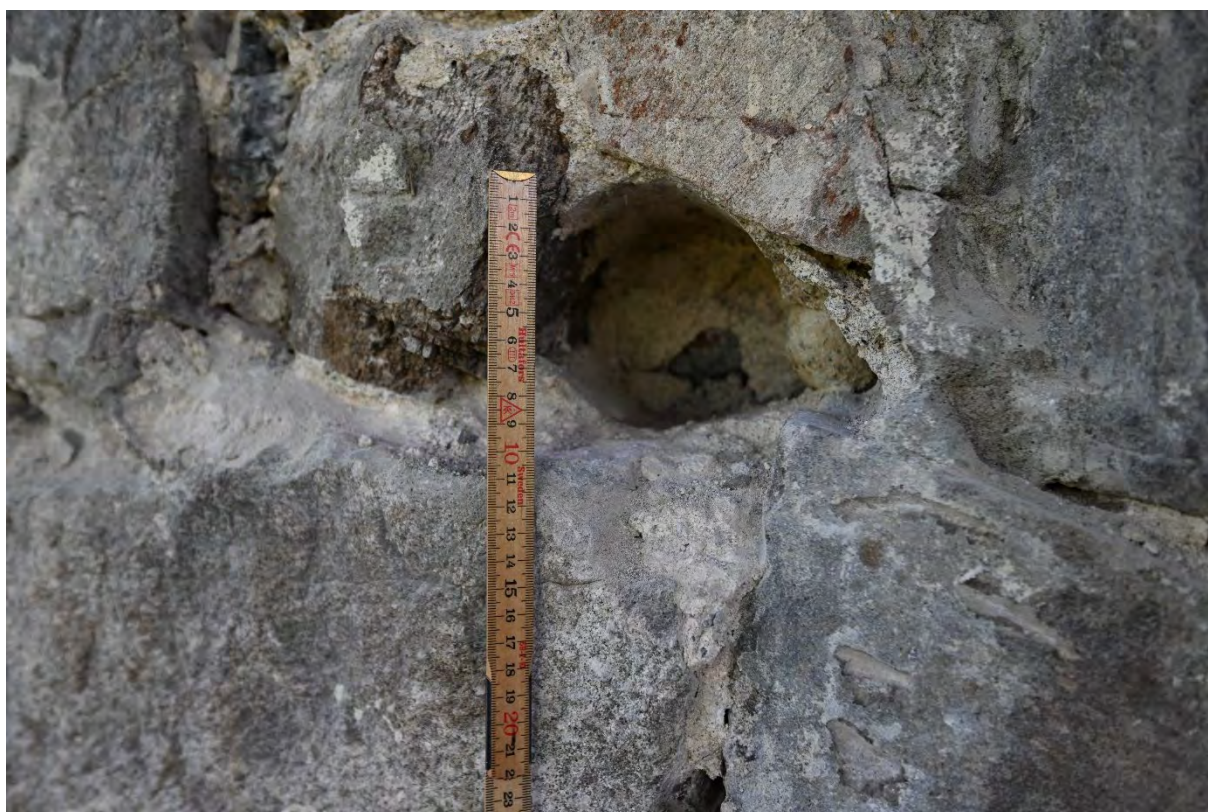
Fig. 46. Nordveggen, stillashull nr. 2 i fig. 48 og 49 under, etter at de løse steinene var fjernet. Det negative avtrykket etter den innmurte stillasstokken har en diameter på ca. 9 cm og en dybde på ca. 15 cm.
