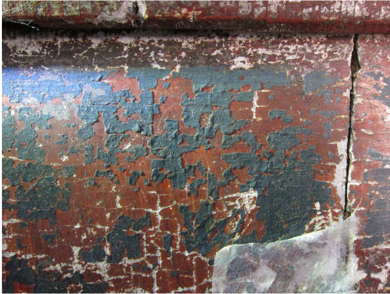
Eksempel på skadeomfang i bakveggen. Bildet viser den avskallinger ned til hvit grundering, rød bolus og i den blå overmalingen.
