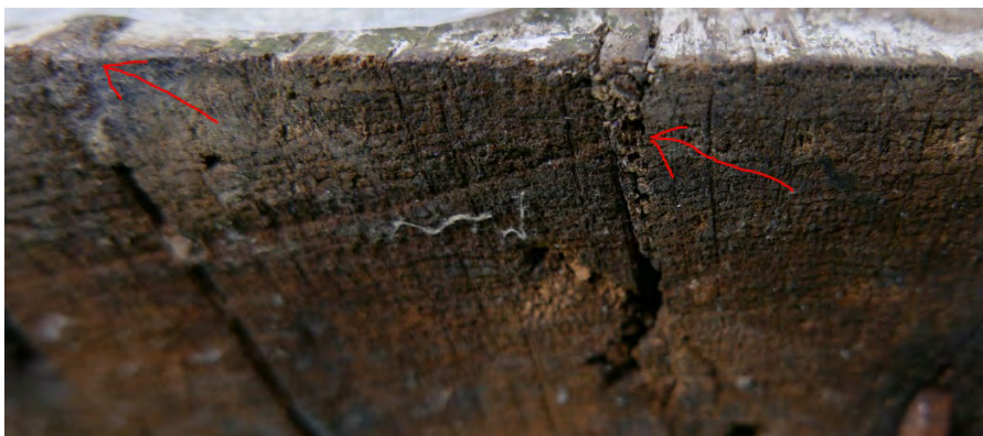
Detalj, underside St. Kristoffer. Pilene peker på innspunsinger i sprekker.
