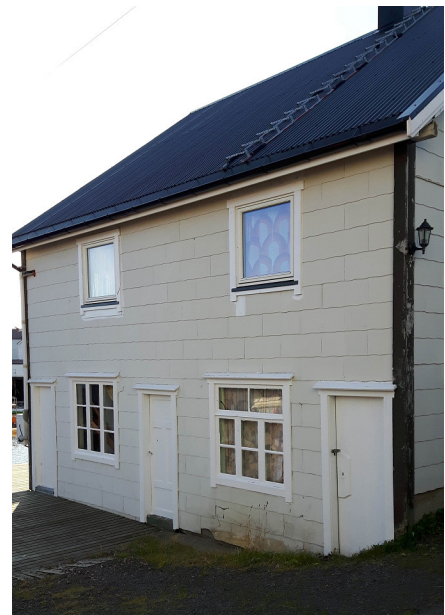
Eternitt er et materiale som ble populært på grunn av sin holdbarhet i værharde strøk fra 1950-tallet. Eternitten inneholder asbest, men kan erstattes med asbestfrie alternativer
