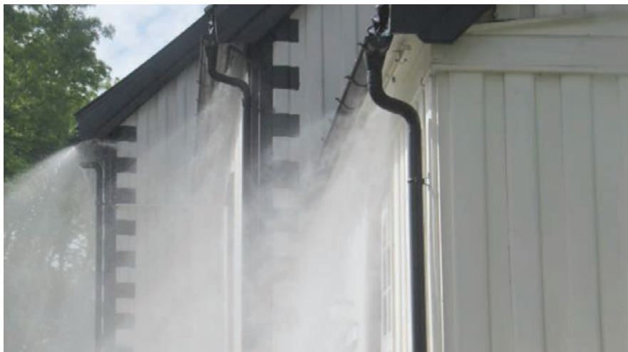
Vanntåke under takutstikk (FireKill). Sprinkler monteres på tilsvarende måte.
