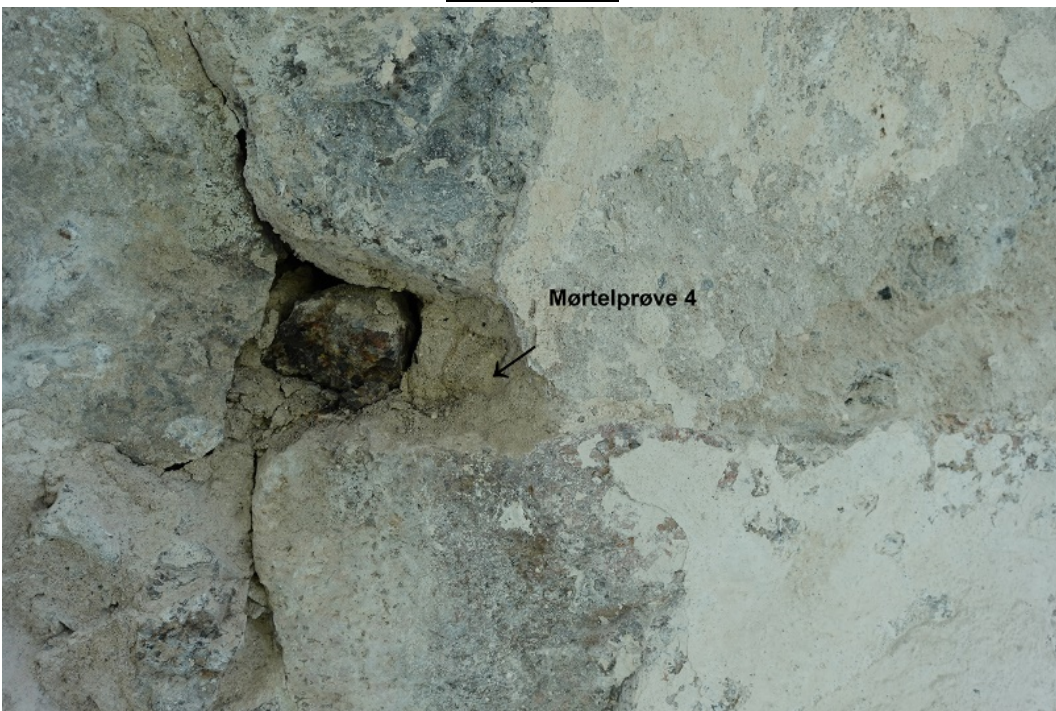
Fra muren øst for portalen. 255cm fra innsiden av østre sidevange i portalen, 190 cm over bakkenivå.
