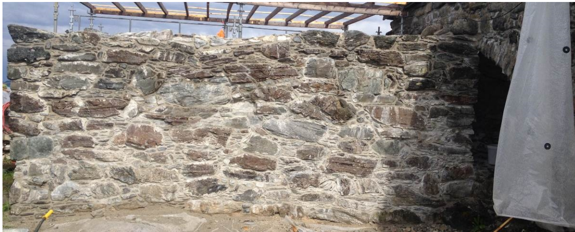
Foto 20061138_093: Vestre side av mur mellom rom 101 og 102 ferdig spekket.
