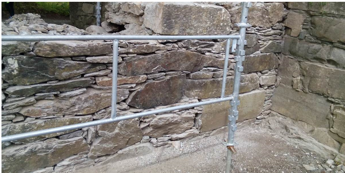
Foto 20140809_120: Deler av vestmurens østre side mot nord ferdig meislet. Legg merke til manglende forbant mot tilstøtende vegg.
