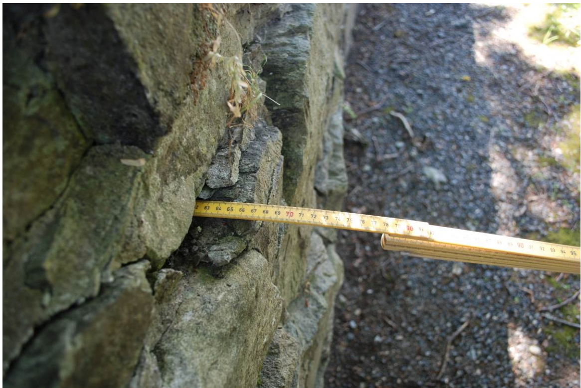
Foto 20052208_010: Eksempel på manglende og oppsprukket fuge med tomrom bak. Dybde inn til murkjerne var omkring 70 cm. Bildet er tatt før inngrep.
