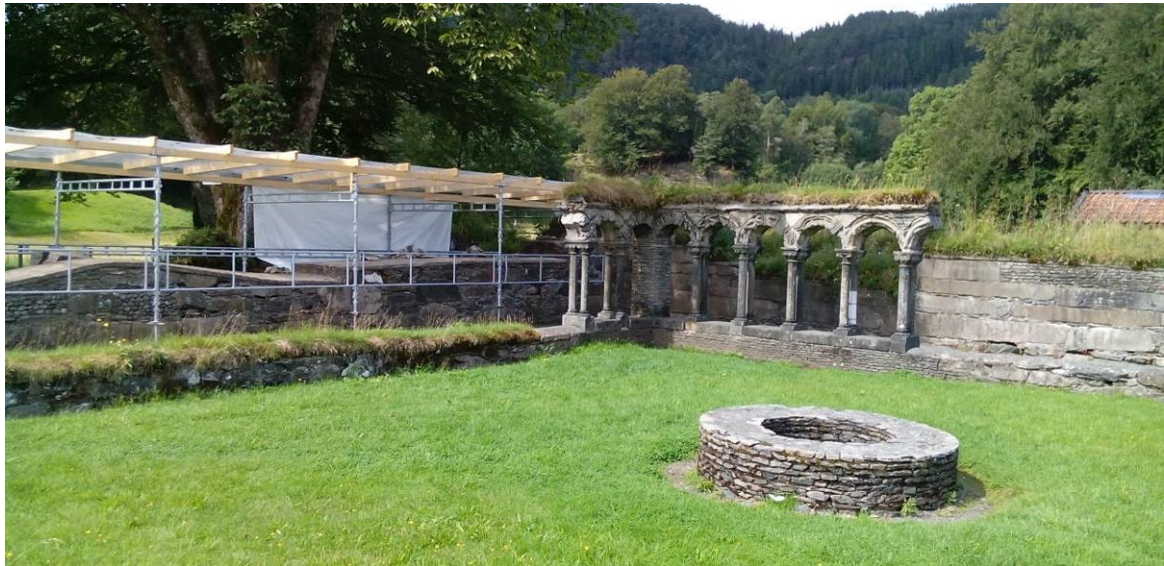
Foto 20140804_152: Toppdekke rensert for jord og vegetasjon. Tak over ruinen er montert og meislingsarbeidet startet.
