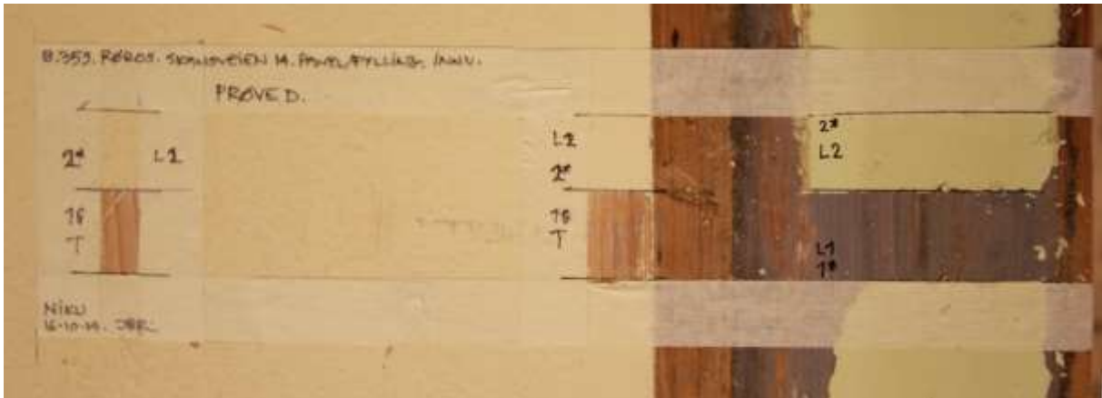
Fig. 4. Røros. Skansveien 14. Panel, prøve D. Foto: J. Brønne 2014.
