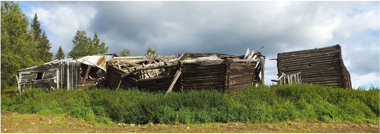
Figur 42: De store driftsbygningene har høyest tapsandel av bygningskategoriene (5 %) i 5. omdrev, en økning på 1 % siden forrige omdrev. De har også høyeste akkumulerte tapsandel i 1. – 5. omdrev (32 % mot 26 % i gjennomsnitt). Foto: ASB/ASPLAN VIAK 2020 (5420021009).
