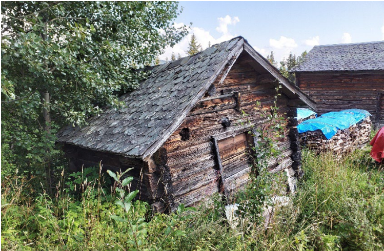
Figur 44: 21 % av sidebygningene (her et bryggerhus) er truet, mens 7 % tapt i 5. omdrev. Dette er høyere enn gjennomsnittet for de undersøkte bygningene i kommunen. Foto: ASB/ASPLAN VIAK 2020 (5420004088).
