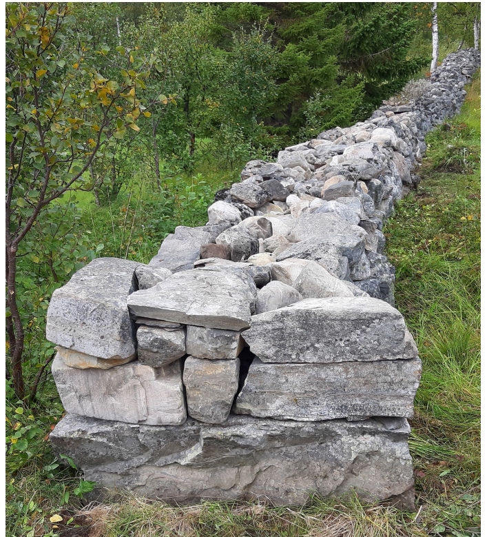
Ferdig reparert mur. Legg merke til hvordan kistemuren er bygd opp, med steiner på begge sider og deretter fylt igjen med mindre steiner.
