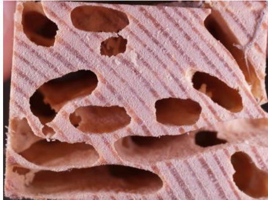
Foto 2. Fordi larvene fordøyer treverket, blir treverket ødelagt.
