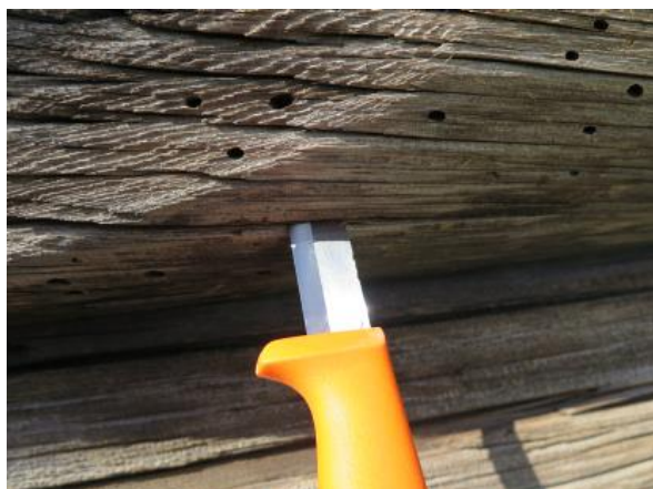
Foto 8. Det kan oppstå omfattende svekkelse av de indre delene av treverket før skadene oppdages.
