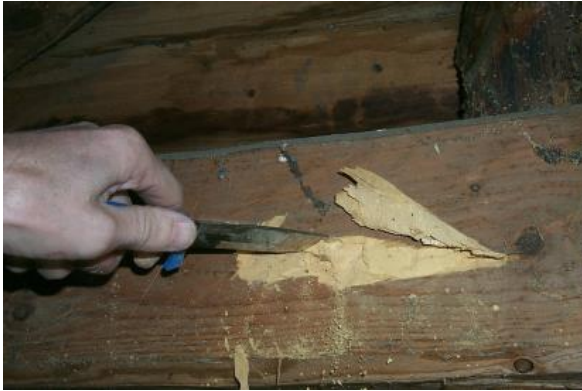
Foto 1. Husbukken forårsaker svekkelse av treverk.
