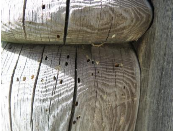
Foto 9. Ofte oppdages husbukkangrepene ved at man finner utflygningshullene som viser hvor de voksne billene har forlatt treverket.
