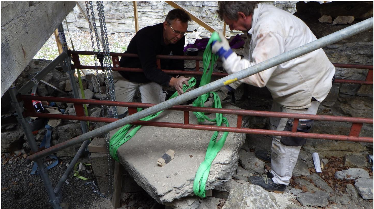
En solid rigging måtte til for midlertidig å kunne heise unna den store steinhella i Kn. Hver stropp tåler ett tonn.
