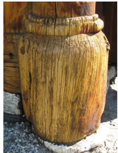
Bilde detalj: Torpo stavkirke. Her ser vi vannslitasje på treverk over lang tid. Foto: Tone Marie Olstad, NIKU
