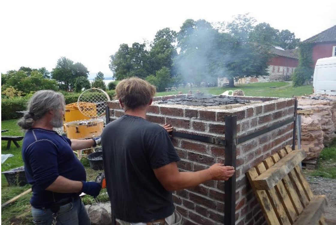
Kalkovnenes munkeforbandfasade ble forsterket med hjørnestål.
