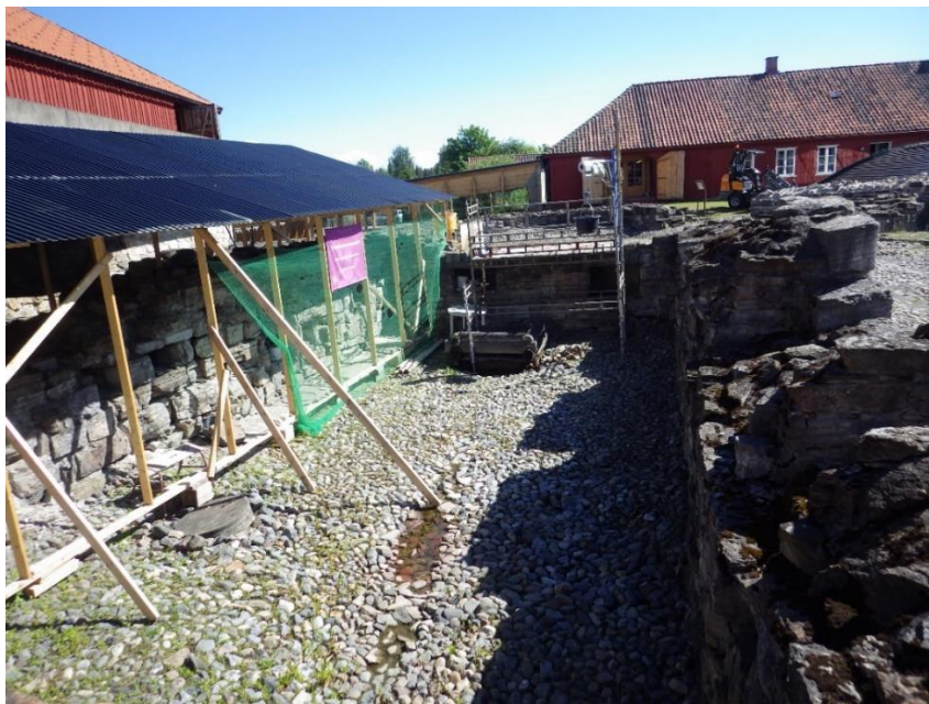
Tårnkjelleren sett mot øst. Stillas, heis, vernebygg og innleid mini-dumper var en forutsetning for gjennomføring.
