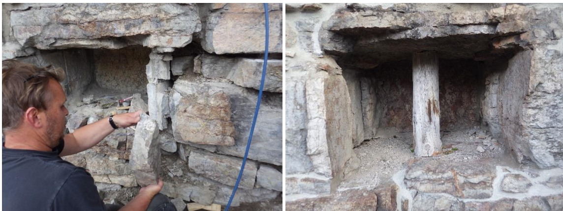
Nisjene i tårnkjelleren har sprø toppheller som tidligere delvis er understøttet.
