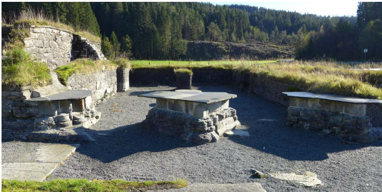
Figur 21. Portalbasene etter reparasjon av fugene i toppdekket, fotografert mot NV (Foto: Byantikvaren 2017).
