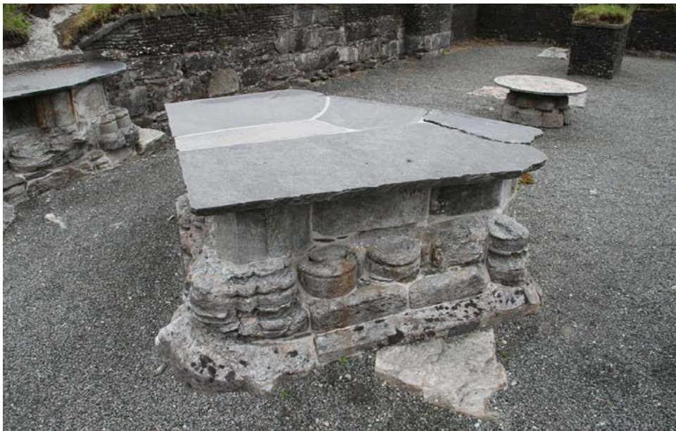
Figur 19. Løs dekkehelle i portalbasen i kapittelsalen (Foto: Byantikvaren 2016).
