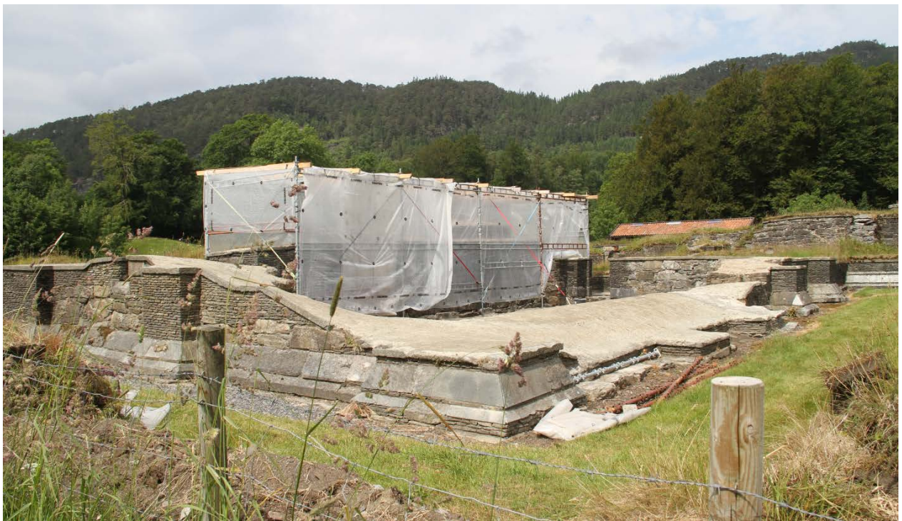
Figur 3. Partier av murene ble dekket til underveis for å sikre gode arbeidsforhold og betingelser for herding av kalkmørtelen (Foto: Byantikvaren 2016).
