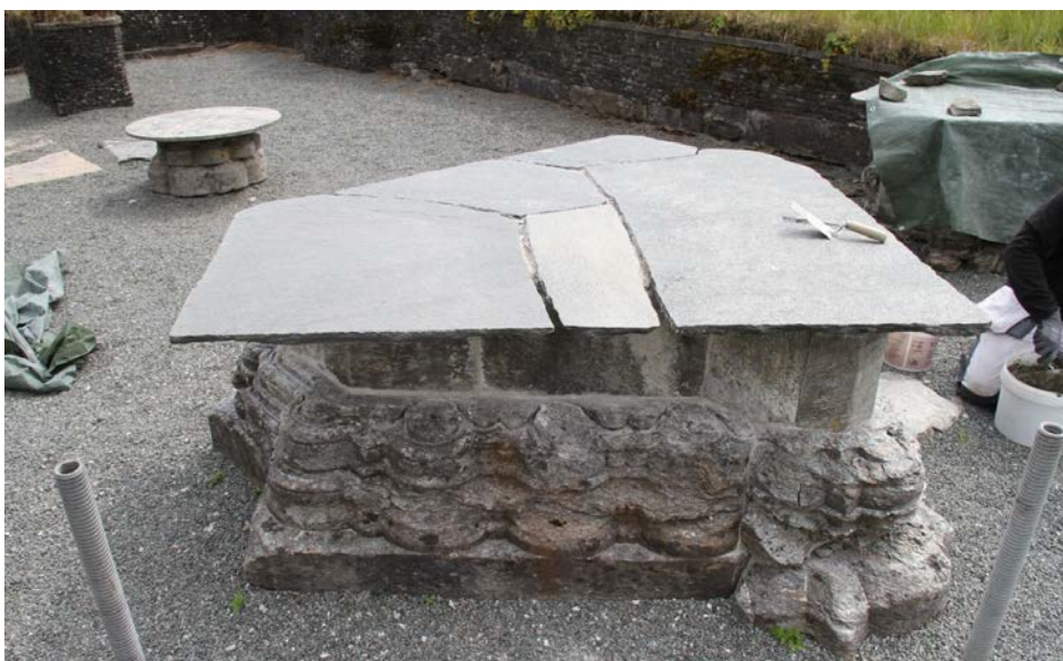
Figur 20. Fugene mellom dekkhellene ble rensset, og deretter limt og fuget på nytt (Foto: Byantikvaren 2016).
