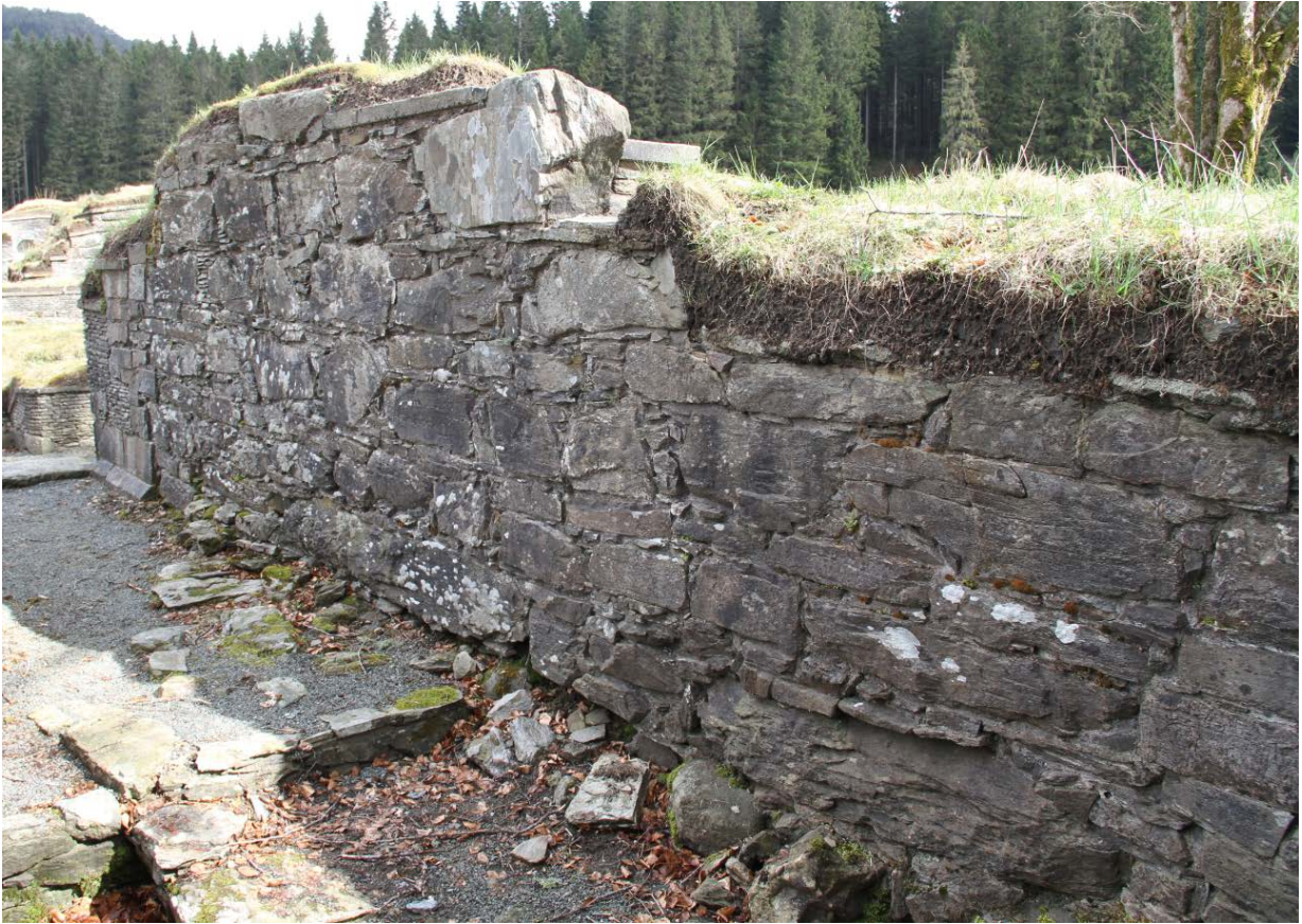
Figur 13. Ytre murliv i vestmuren i dagrommet før tiltaket. Langs murfoten var det særlig mange sprukne fuger og løs stein (Foto: Byantikvaren 2016).
