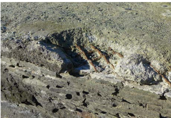
Figur 5. Enkelte steder ble det konstatert skader i sementdekket etter at torvlaget var fjernet (Foto: Byantikvaren 2016).
