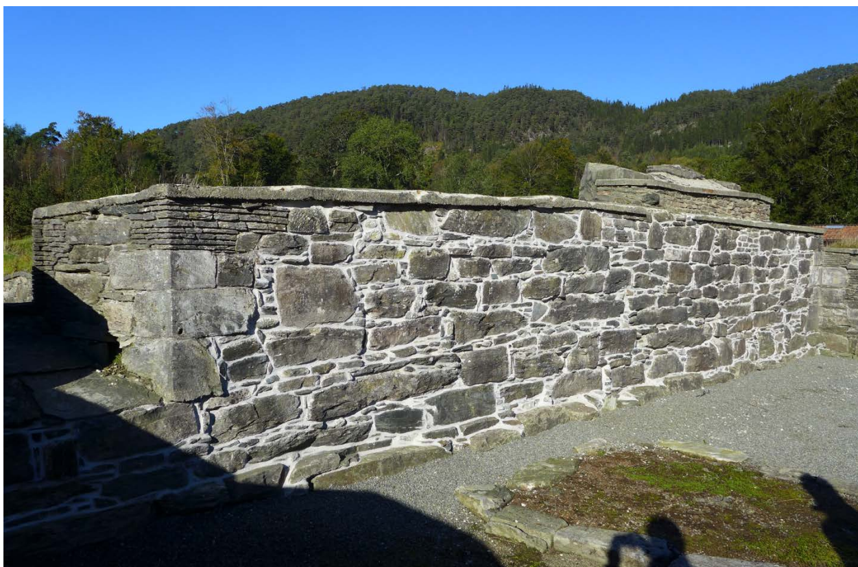
Figur 12 Torvlaget på toppdekningen ble fjernet og fugene rensset for sementbasert mørtel. Deretter ble muren spekket med naturlig hydraulisk kalkmørtel (NHL-3,5). Sementdekket på murkronen, som stammer fra istandsettingen på 1920-tallet, bevares da det har en stabiliserende effekt for murverket (Foto: Byantikvaren 2016).
