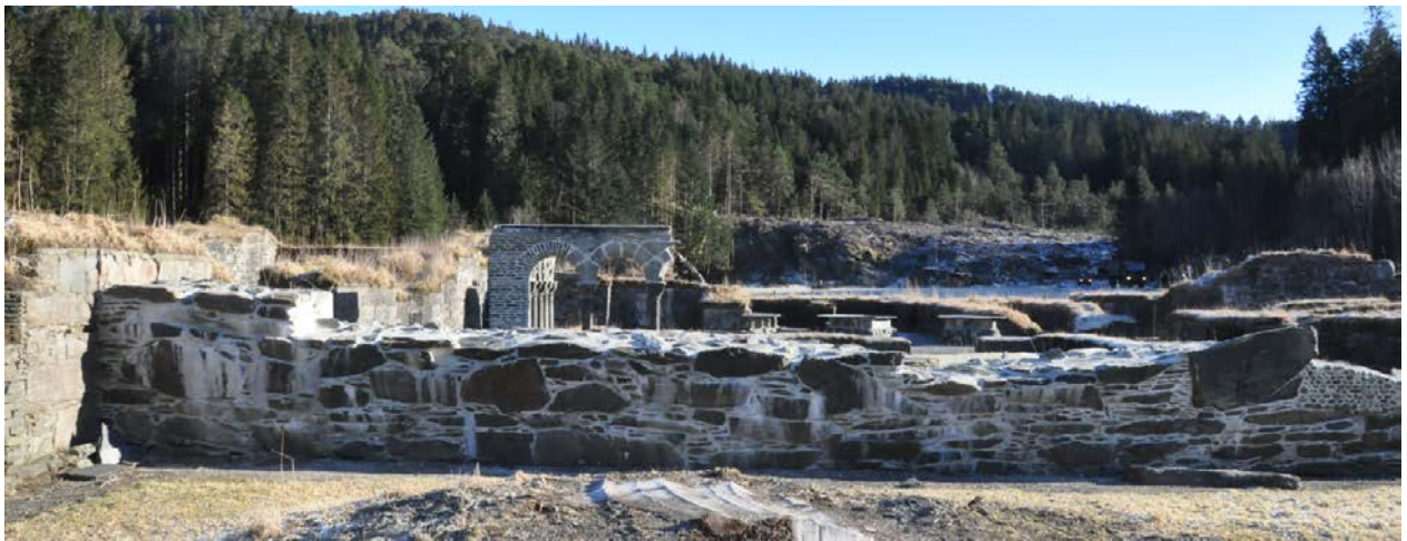
Figur 17. Det oppstod tydelige kalkutfellingger i murlivet til vestmuren i løpet av vinteren 2015/2016 (Foto: Byantikvaren 2016).
