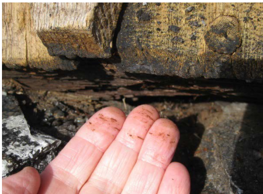
Deler av svillstocken på sørsida har råte og viser tegn på før høy fuktbelastning. Det skyldes trolig steinens plassering og avstanden fra spon til stein.
