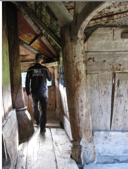
Omgangen mot vest og inngangsparti synes å være dårlig fundamentert. Det er mulig at konstruksjonen har sklidd vestover for lenge siden og nå er stabil.
