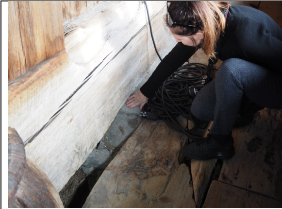
På enkelte steder er fundamentering av skipets sviller konsolidert med sementholdig mørtel.
