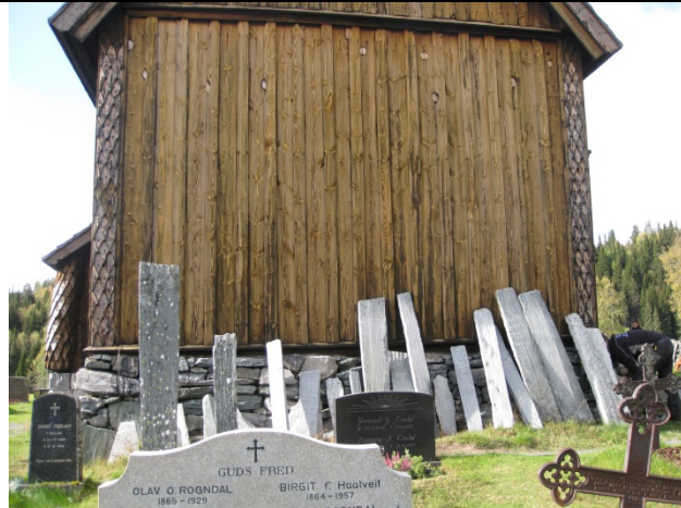
Østvegg på kirka. Spunsinger i veggen viser at det har vært et problem med hakkespett.
