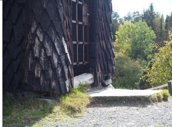
Vestinngang. Terskelstokken bør holdes frie fra gress og planter for å unngå unødvendig fuktbelastning.
