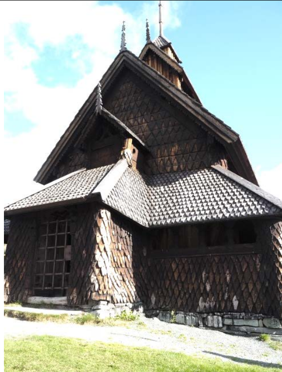
Portal og vestfasade. Bakken har god helling ut fra kirka, men planter og vekster bør likevel fjernes fra grunnmuren for å unngå fuktrelaterte problem.
