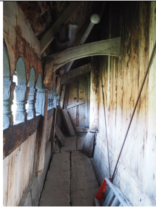
Gulvbordene i svalgangen, her på nordre side, ligger flere steder rett på jorden, og mangler dermed tilstrekkelig lufting under.
