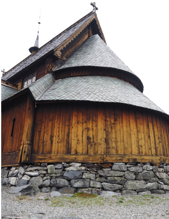
Søndre side av apsiden. Tydelig slitt av vær og vind.
