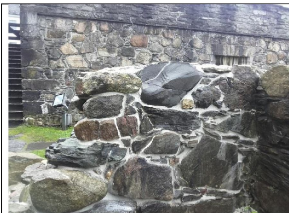
Nordsiden av murvange (sørmuren) etter at partiet er fuget ut med kalkmørtel
