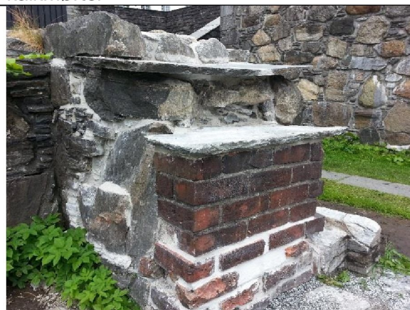
Teglvange og innside av sørsmuren, østre del. Betongfuger i dørterskelen er her hugget opp og erstattet av grus
