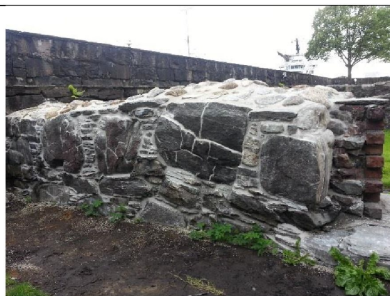
Sørsmuren, vestre del sett fra utsiden (fra SØ). Stein limt med epoxylim lengst til høyre
