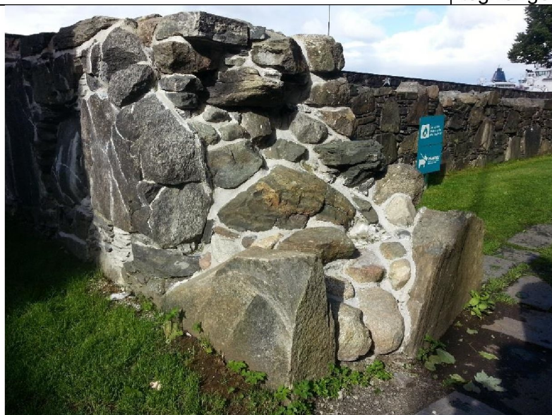
Østre del av sørmuren ferdig utbedret i august 2016. Steiner og kalkmørtel-fuger er lagt slik at det skal være god avrenning. Etter at arbeidet ble ferdigstilt ble det også lagt en ca 30 cm bred «grus-sperre» langs med muren for å hindre begroing inntil murverket
