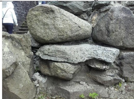
Nordsiden av murvange (sørmuren) nærmest Håkonshallen etter at sementmørtel var krasset ut. For dokumentasjon av sørsiden før tiltak: se bilde over
