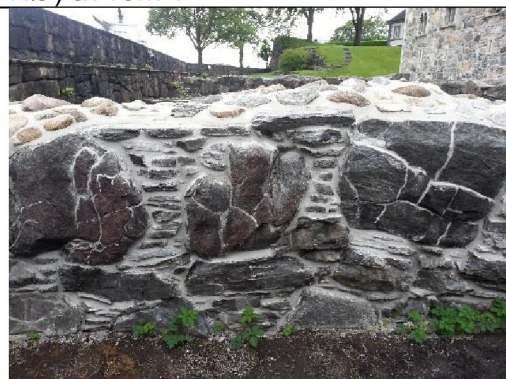
Utsiden av sørsmuren, vestre del. Større stein som var sprukket helt opp ble limt med epoxylim i 2014, mens steiner som bare hadde mindre sprekker, ble fylt med kalkmørtel
