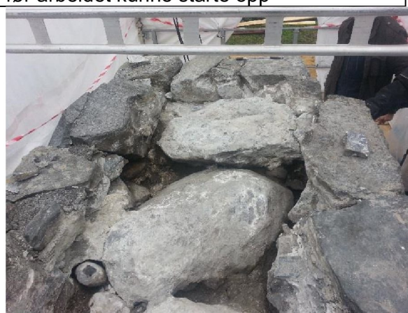
Østre del av mur etter at murkrone i sement var fjernet. I denne delen var det en rekke store steiner som var lagt inn i toppen av kistemuren
