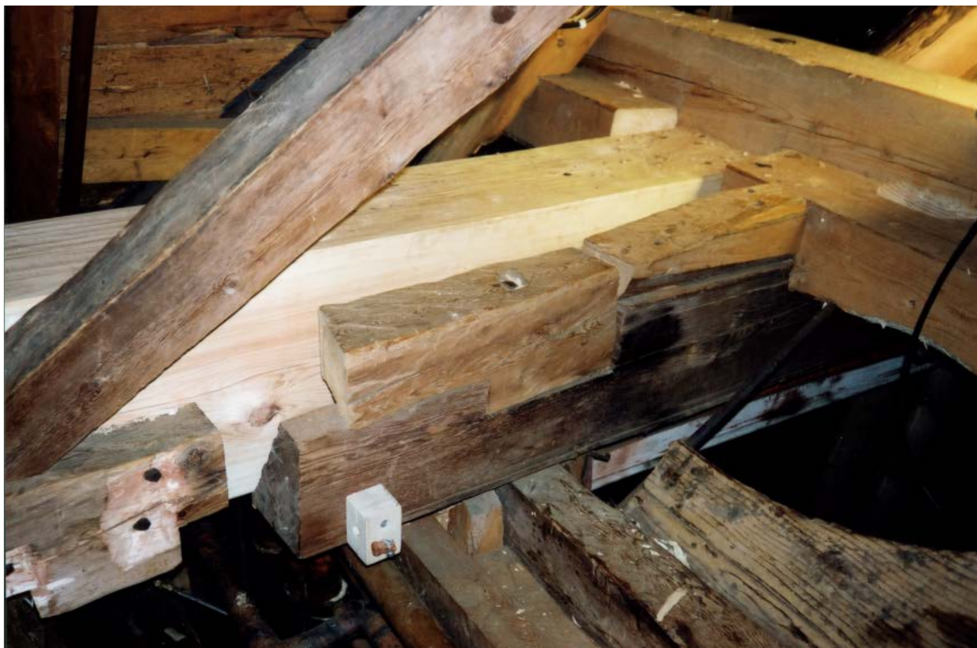
Bering av takryttar: Utbetra avstiving med nye stokkar over mellomstavane. Jarnklemmer er fest til eldre bjelkar. Foto: Riksantikvaren
