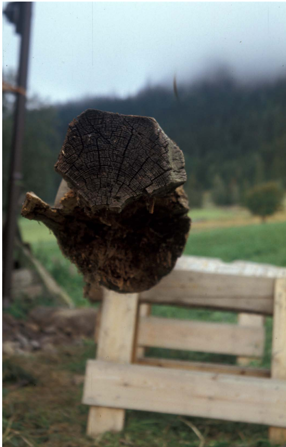
Røteskade: Ein av stökkane frå støpulen. Foto: Hans Marumrud, Riksantikvarens arkiv.
