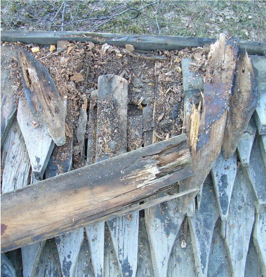
Røteskade: Mykje røteskade i spona på taket til kyrkjegardsmuren. Foto: Are Flaten, Riksantikvarens arkiv.
