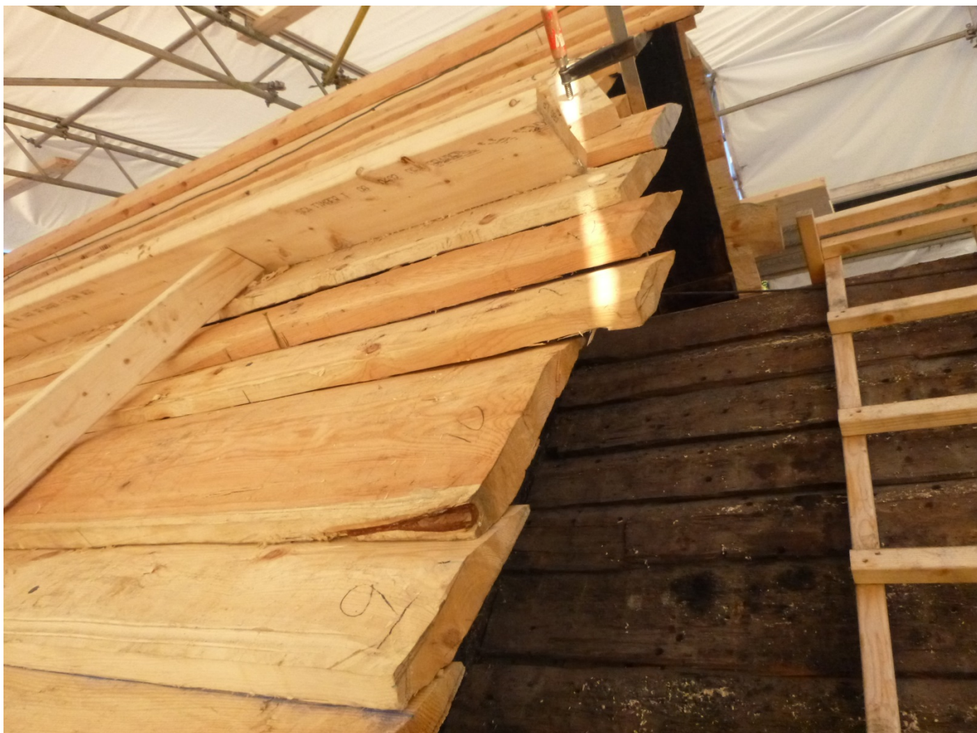
Sulagt tak: Nytt og opphavleg sulagt tak på skip og kor. Foto: Bård Strømgren, Riksantikvarens arkiv.
