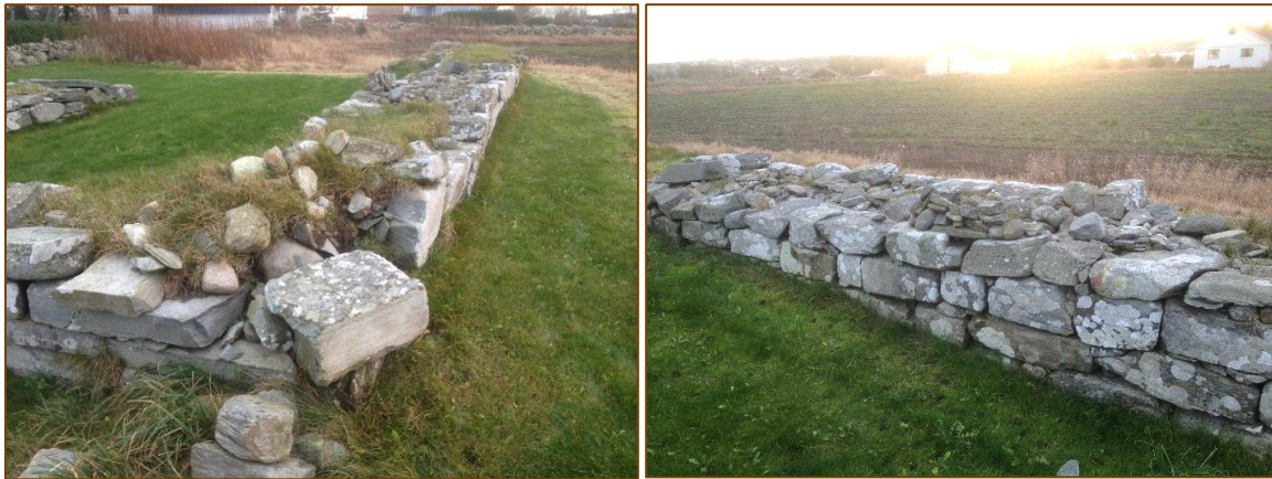
Figur 10(a): Ytre vangen av det sydvestlige hjørnet. Kollaps har ført til at murkjernen ble eksponert og uten støtte (b): Indrevangen av sørveggen. Murverket var i relativt god og solid stand.
