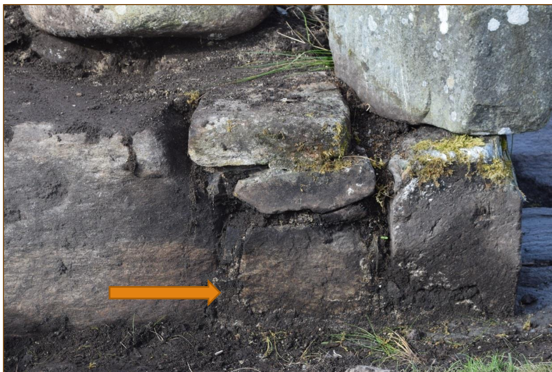
Figur 20: Indrevangen, vestvegg. Pilen peker på kalkmørtel i en stussfuger på det nedre skift av murverket.
