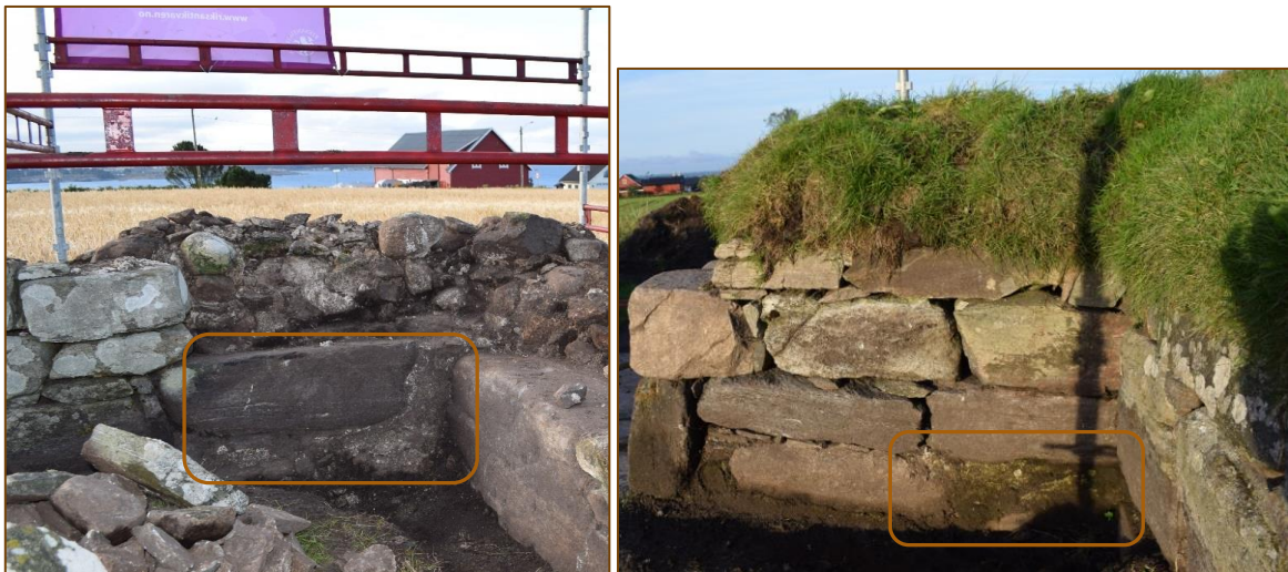
Figur 34: Områdene med rester av opprinnelig kalkpuss på indrevangene (a): sørvestlige hjørnet (b): nordvestlige hjørnet.
