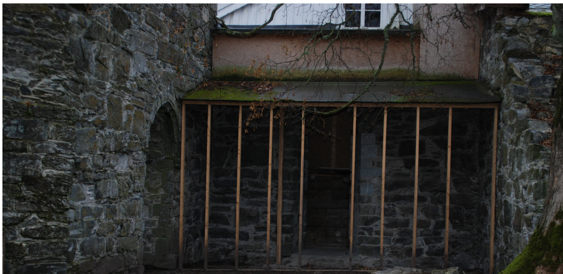
Vernebygg i søndre tverrskip som ble revet og levert godkjent deponi våren 2015
