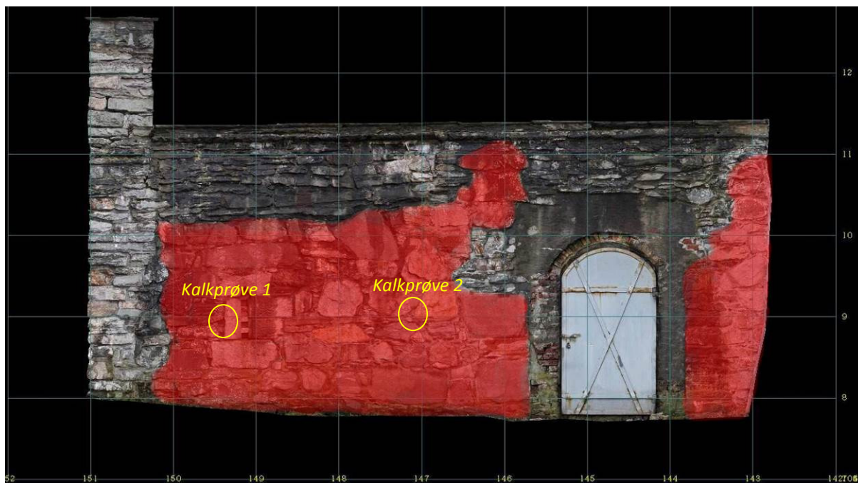
Fig. 24. Terrassens murliv mot øst (fotogrammetridokumentasjon, Marcin Gladki 2010). En grov markering av det som er tolket som middelaldersk murverk er angitt med rød farge. Gule ringer markerer prøveuttak for kalkprøver.
