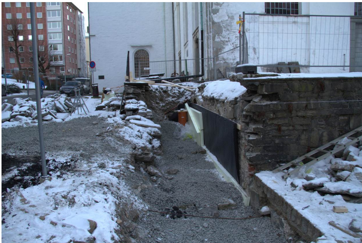
Fig. 7. Her er sjakten foran murlivet fylt igjen med drenerende masser/pukk. Nederst i sjakten, langs veggen under ruinens grunnivå, er det lagt dreneringsrør som fører til en kum ute i gaten. Murlivet har fått et beskyttende dekke mot fukt i form av membran og dobbelt lag med isolasjonsplater (foto: Byantikvaren 2012).
