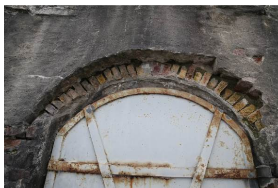
Fig. 28. Teglbuen over døråpningen er ødelagt og må sikres (foto: Byantikvaren 2103).
