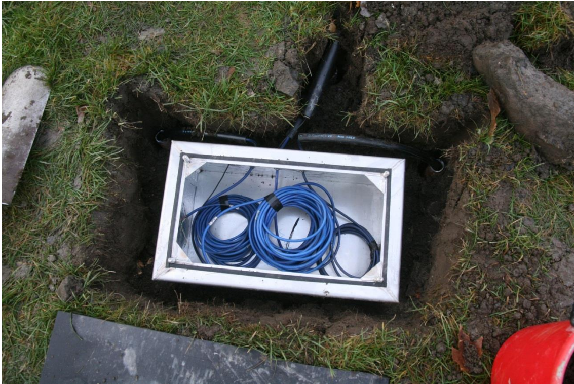
Figur 16: Vann og frostsikret boks, sett ovenifra.
