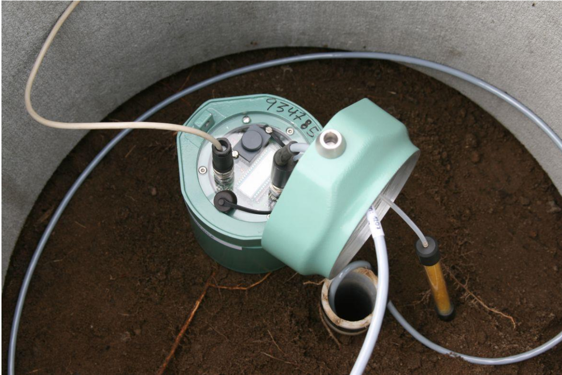
Figur 6: Logger fra peleprosjektet. Loggeutstyr sett ovenfra. (Foto: niku_ark_307755).
