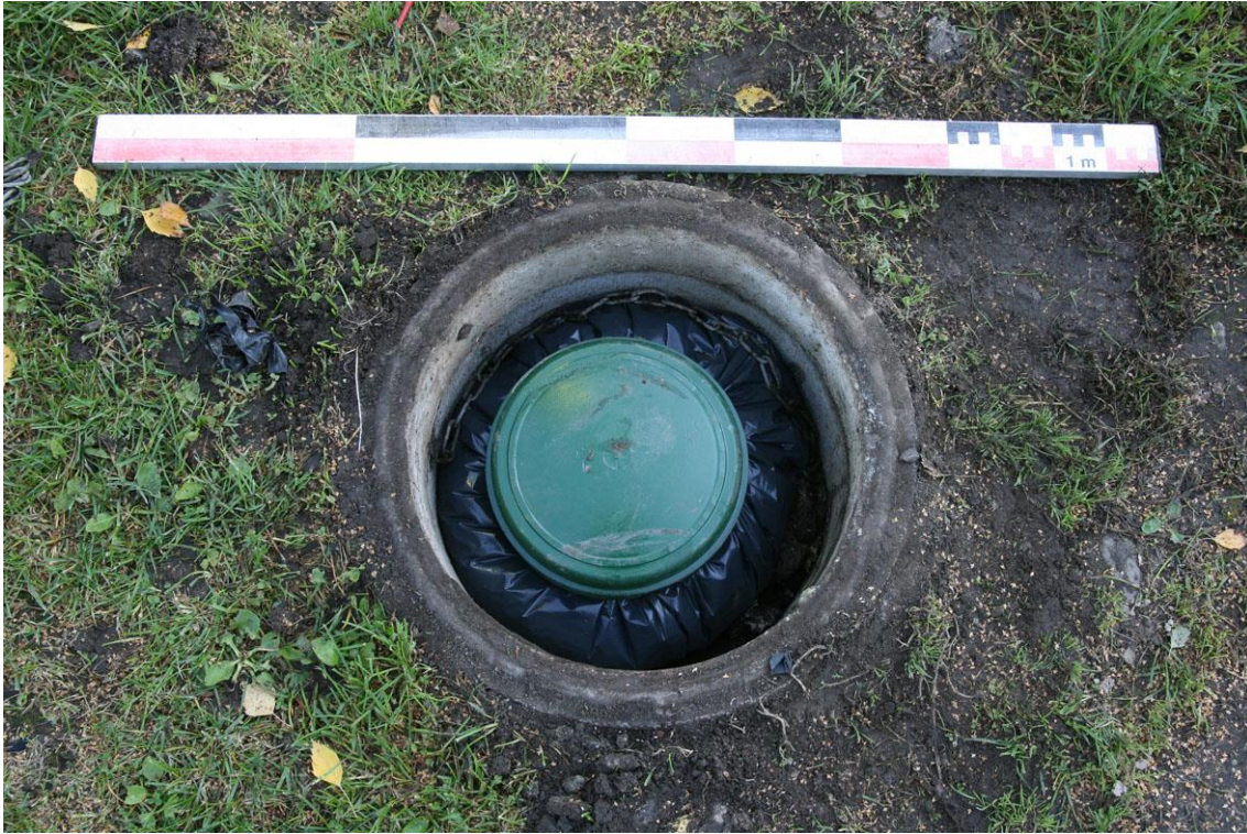
Figur 14: Tiltak for å hindre vanninnsig og drukning av loggeren
