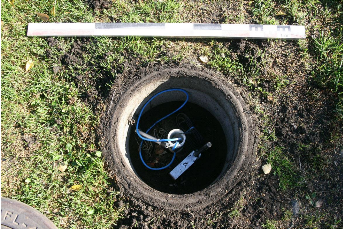
Figur 8: Nye multisensorer etter etablering i brønnrøret, BP 14 (Foto: niku_ark_310039)
