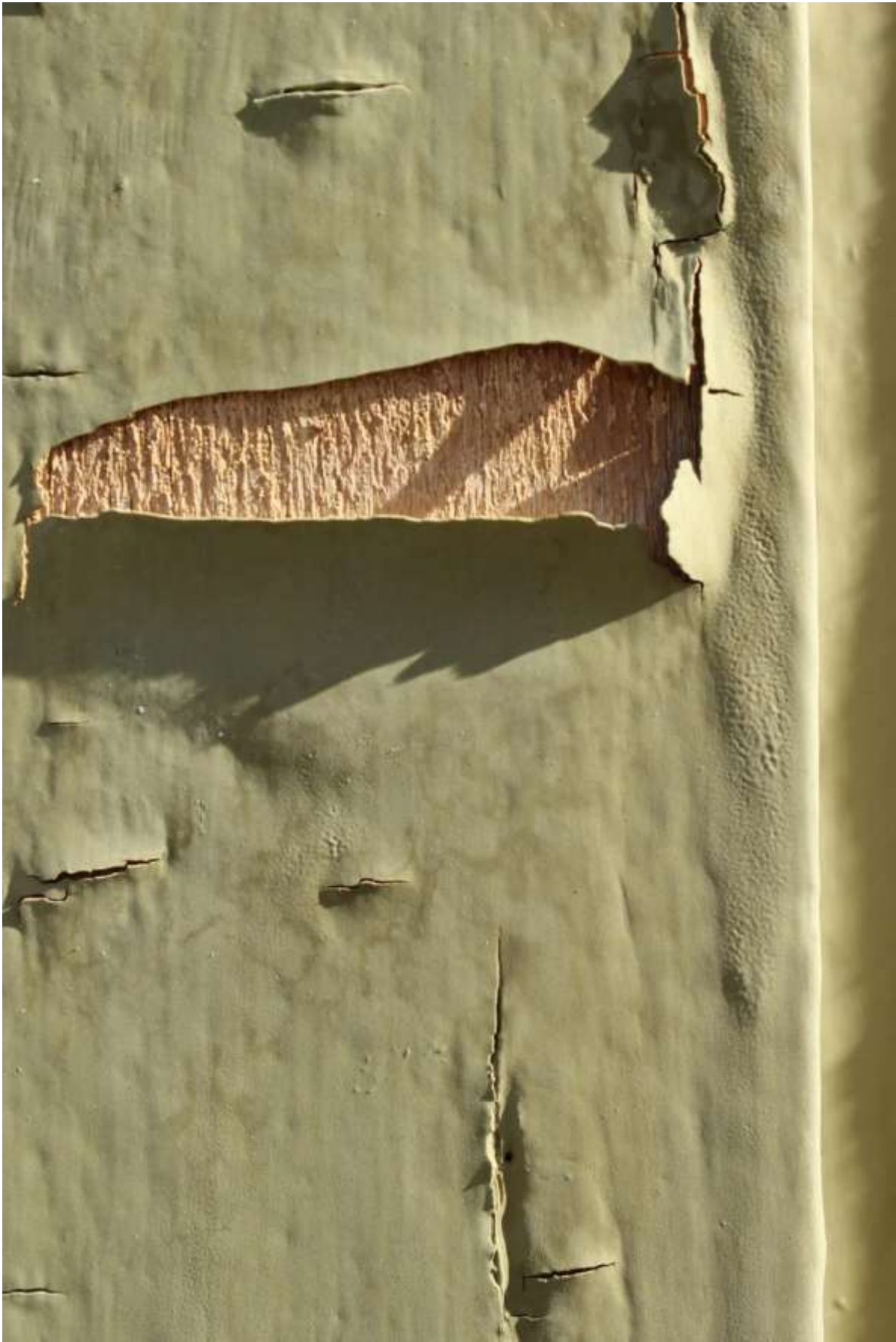
Figur 7. Ole Guldalsgate 10. Panelet, detalj av skader i malinglagene, forårsaket av det fete gul oker oljelaget som panelet ble grunnet med i 1947. Foto: Jon Brønne. 2015.
