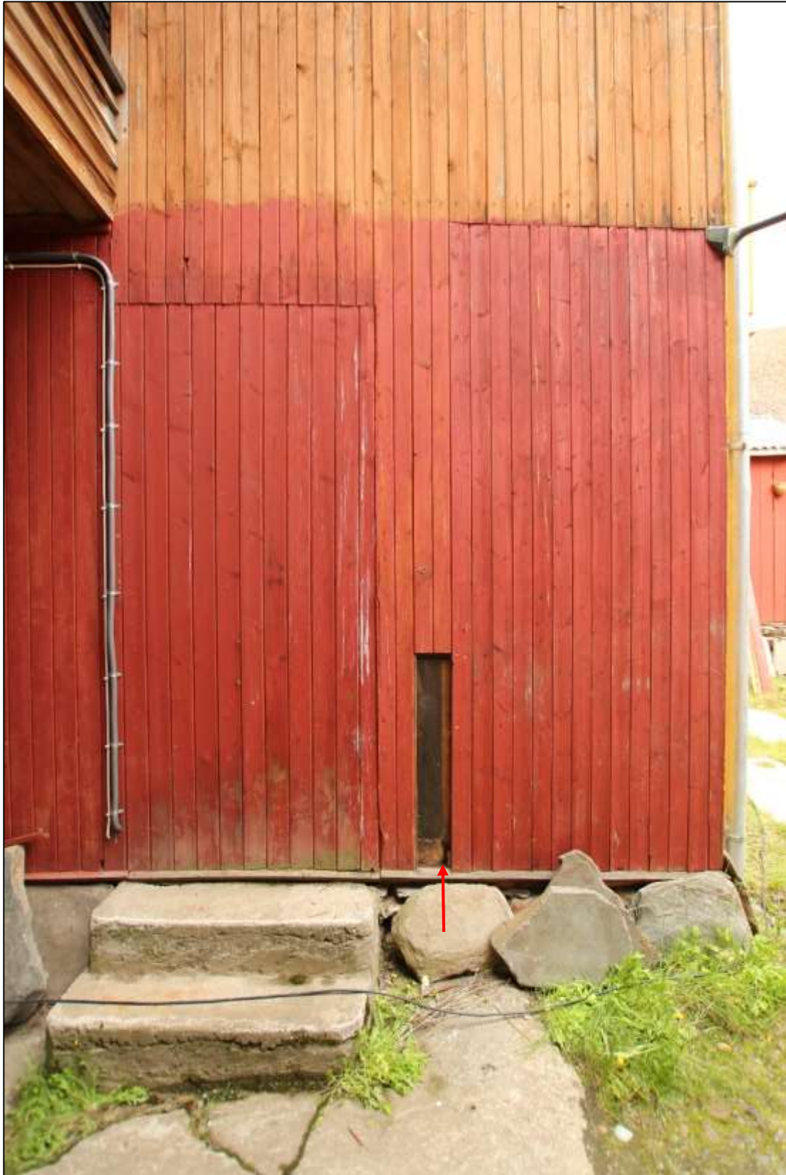
Fig. 4. Røros. Sleggveien 3. Nedre del av sydøstre del av sydveggen. Til høyre sees den sekundære innkledningen og panelet på det som tidligere var det avkuttete hjørnet mot sydøst. (Merket A. på fig. 8.) Til venstre for dette panelet er det fjernet en del av et opprinnelig panelbord med «Trønderpanel» fra 1908. I åpningen synes svilla med den skrå forhugningen fra 1908 for det avkuttete hjørnet. (Rød pil). Til venstre for dette sees trappa som ledet inn til den sekundære inngangen til trapperommet, og det sekundære panelet som er påsatt der den sekundære inngangsdøra stod. (Merket B. på fig. 8.) Dette nedre feltet av sydveggen og panelet i resten av sydveggen i portrommet er malt engelsk rødt med linoljemaling. Foto: J. Brønne. 2014.
