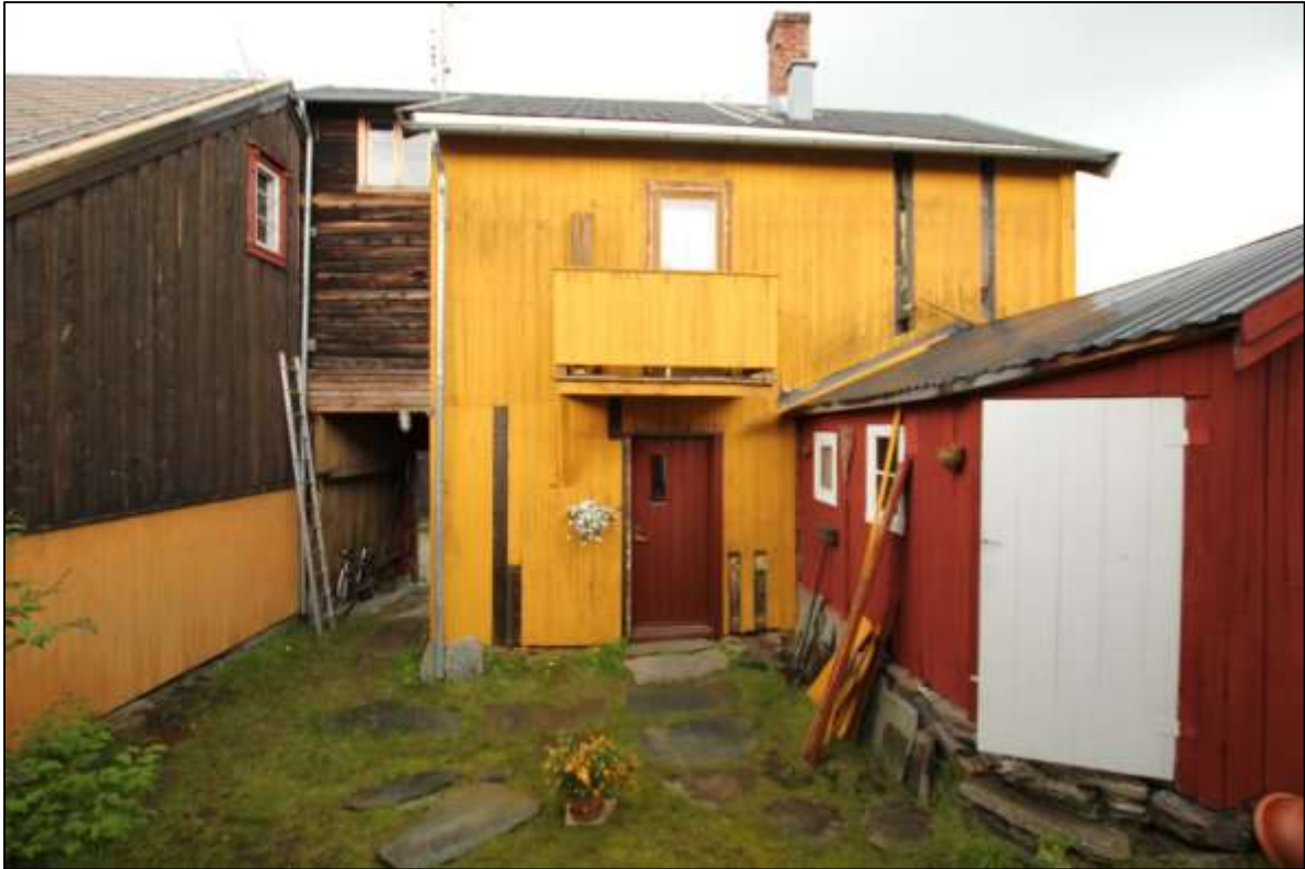
Fig. 6. Røros. Sleggveien 3. Østveggen. Panel og gerikter er fjernet i 1. og 2. etasje for å kartlegge plasseringer av de opprinnelige vinduene fra 1908. Det var mulig å finne sikker innplassering av nordvinduet. Dette er markert på oppmålingen på fig. 10. Videre er det markert på fig. 7. med snorer som er spendt opp mellom ytterhjørnene i den opprinnelige åpningen i veggen. Plasseringen av sydvinduet i østveggen kunne ikke stadfestes med sikkerhet, men sporene i stenderverket tyder med stor sannsynlighet for at vinduet i 1908 ble plassert slik det er skissert på fig.10. Det vil si omtrent der hvor dagens balkongdør står. Foto: J. Brønne. 2014.
