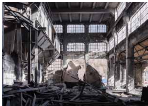
Bygg 104 er en del av Cyanamidkomplekset og fremstår i dag ganske medtatt etter nedrivning og demontering av produksjonsutstyr. Bygningen er ikke fredet men rommer store arkitektoniske kvaliteter og bør istandsettes skånsomt med respekt for bygningens materialitet og stofflighet. Riktig forvaltet kan bygningen ha en katalysatoreffekt i utviklingen av området.
