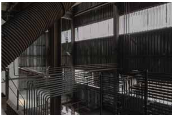
Interiør fra bygg. 70, Ovn 3. Bygget rommer et fasinerende virvar av tekniske systemer
