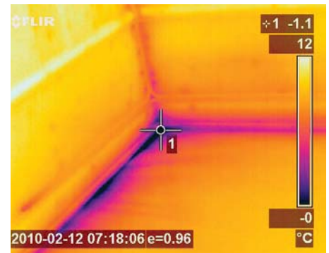
Termografi. Dette bildet er tatt ned mot hjørnet ved gulvet i et rom innvendig. Temperaturskalaen til høyre viser sammenhengen mellom farge og temperatur. Ved overgangen mellom gulv og vegg er det utettheter/dårlig isolasjon som fører til at temperaturen her er nede er 0 °C, mens resten av overflatene har høyere temperatur. Måleresultater Herredshuset i Jessheim.
