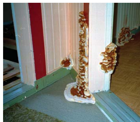
Innblåst isolasjon i bjelkelaget ned mot kjelleren har i dette huset gitt bedre vekstforhold for hus-soppen som allerede var etablert i bjelkelaget. Her burde det vært gjennomført en teknisk tilstandsvurdering, soppsanering og det burde vært vurdert om tiltaket ville ført til økt risiko for nye skader. Foto: Mycoteam.
