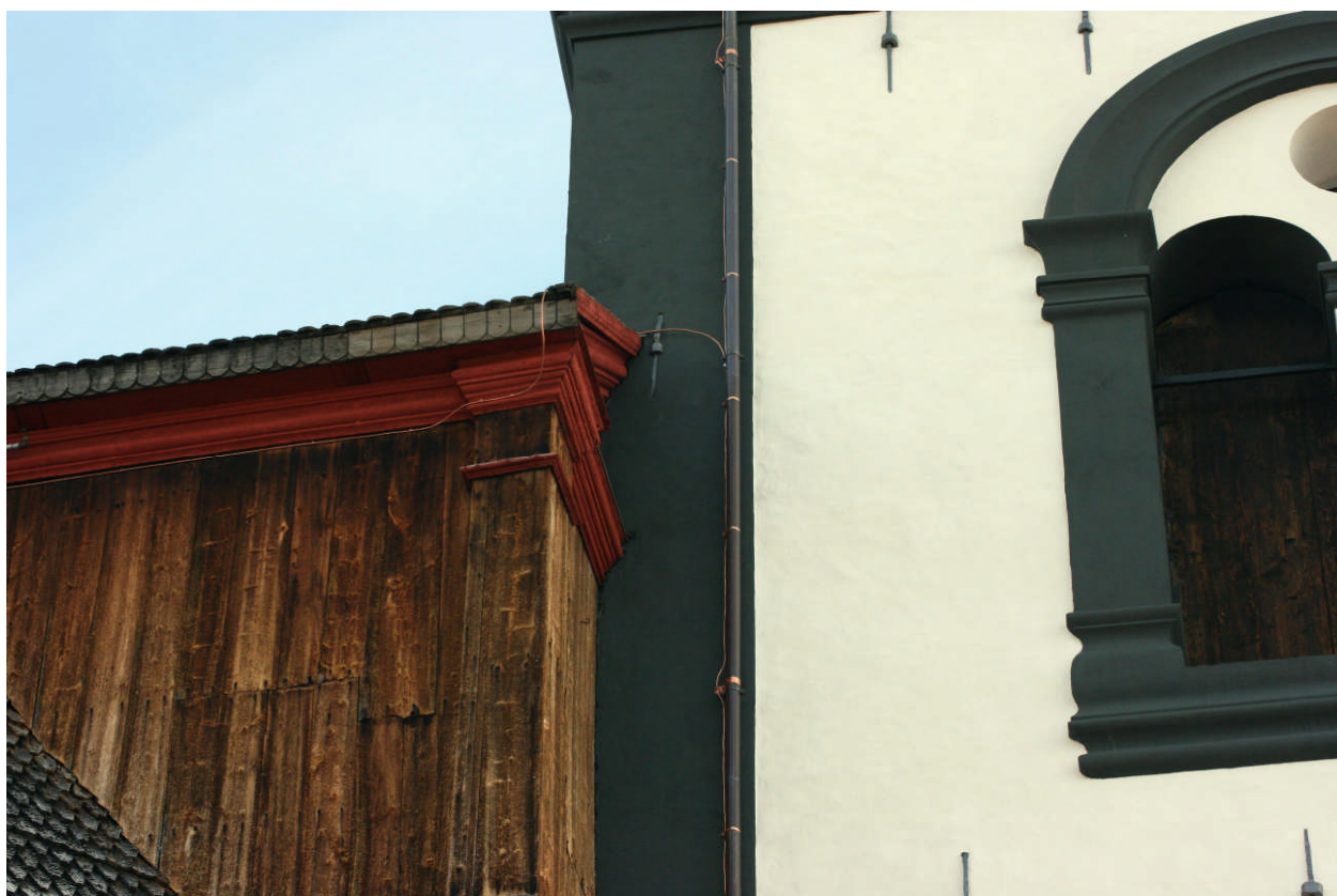
Bilde 7 Et godt eksempel på bruk av vannrør som feste til nedleder. Legg merke til de like avstanden mellom festene.
