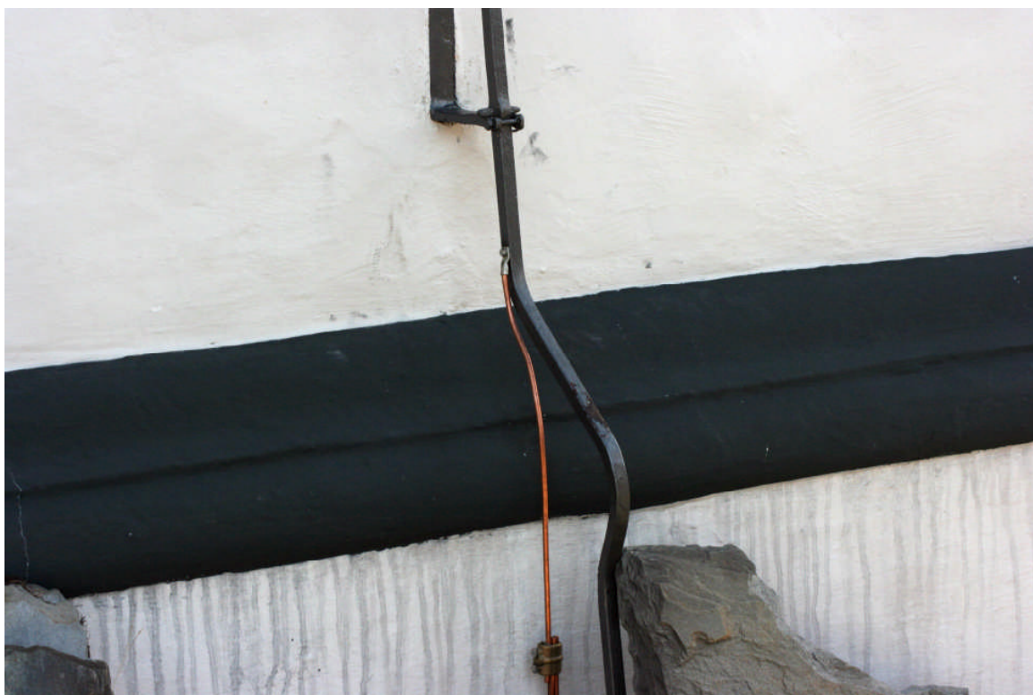
Bilde 9 En fin løsning på jordopptaksklemme, samt en god løsning med møte, ny og gammel nedleder. I dette tilfellet kunne festepunktet vært litt lenger ned (kabelsko).
