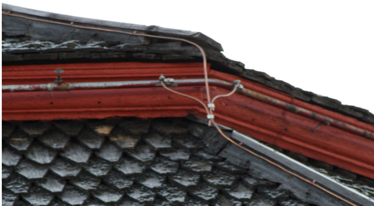
Bilde 6 Her er det fine bøyer, og symmetrisk pent utført. Legg merke til utjevningsforbindelsen til sprinkelanlegget.
