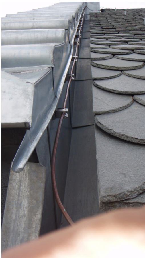
Bilde 1 Her er nedlederen skjult samtidig som den er korrekt plassert i forhold til å gjøre den jobben som er viktigst, nemlig å lede lynet til jord
