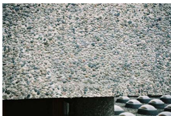
Fig. 4.4 Reparasjonsområdet er nærmest usynlig
