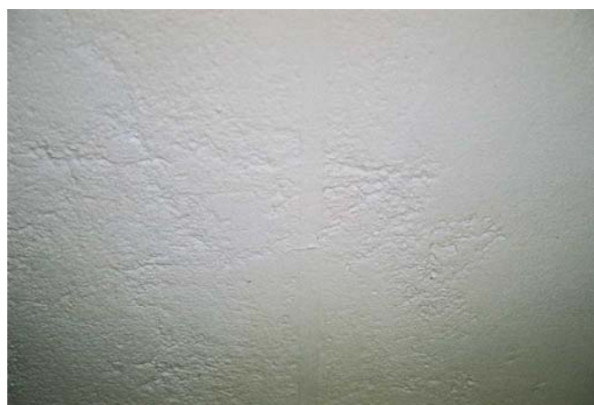
Fig. 6.2 Endret overflatestruktur på grunn av sandblåsing
