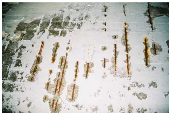
Fig. 2.1 Avskallingskader på grunn av rustsprengning.
