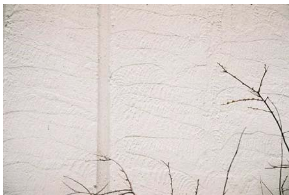
Fig. 8.2 Spor i overflaten etter malingsfjerning
