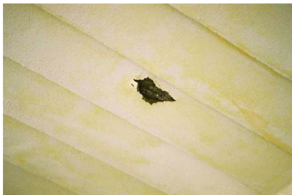
Fig. 5.3 Misfarging og tegn til malingsavflassing på realkalisert flate
