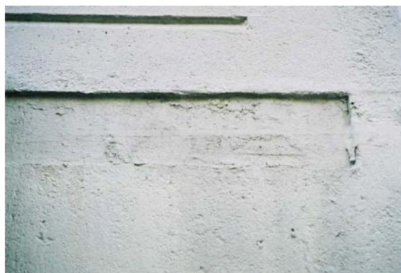
Fig. 8.3 Endret overflatestruktur på grunn av sandblåsing
