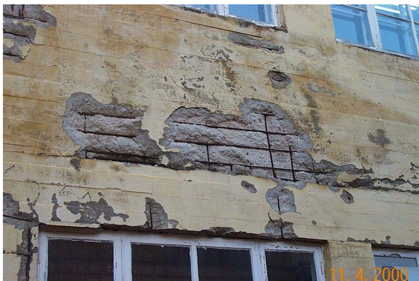
Fig. 1 Eksempel på betongskader på grunn av armeringskorrosjon på fredet bygning.
