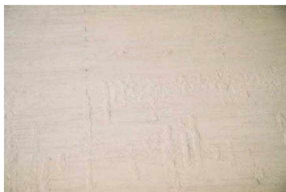
Fig. 4.3 Svært synlige og lesbare reparasjoner
