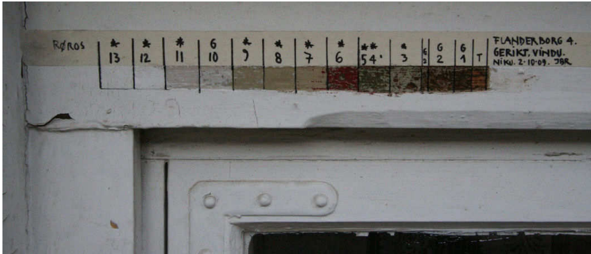
Figur 9. Nedre Flanderborg 4. Fargelagsavdekking på vindu på hovedfasaden. T = Treverk. G = Grunningsstrøk. * = Avsluttende malingslag. Foto: J. Brønne. Oktober 2009.
