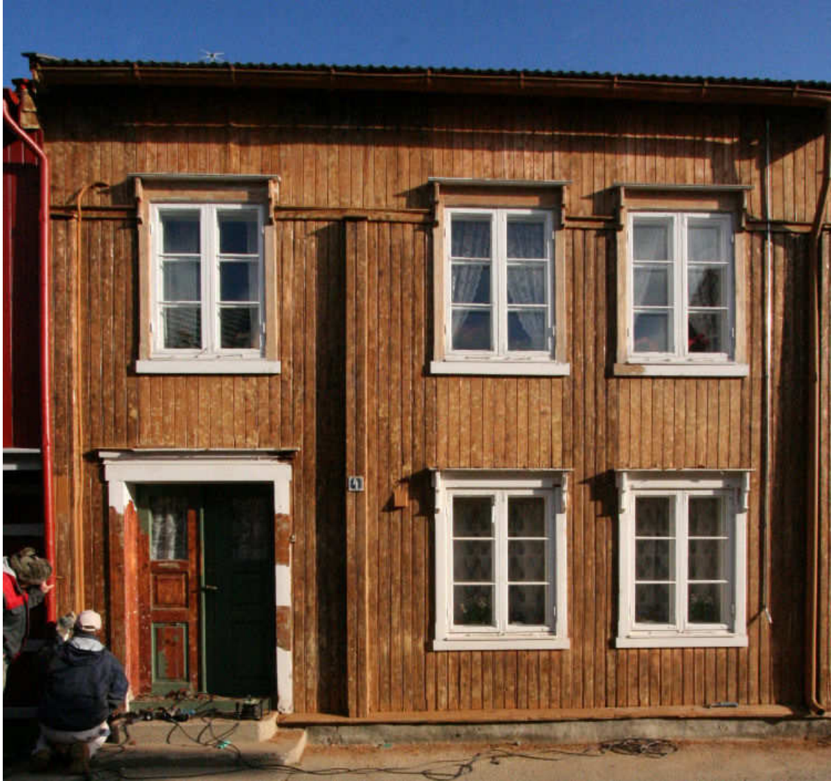
Figur 1. Nedre Flanderborg 4. Fasaden. Det meste av alle malingslag er fjernet. Under alle vinduene i 2. etasje er panelet fornyet. Dette panelet ble fornyet da vinduene ble skiftet, trolig i 1940- eller 1950 årene. Panelet er av en annen type enn originalpanelet, men det er søkt å finne et panel som samsvarer best mulig med det opprinnelige. Vinduene i 2. etasje er utvilsomt større enn de opprinnelige, idet de har ”kuttet av” etasjeskilleren som går mellom 2. etasje og røstet. Foto: J. Brønne. Oktober 2009.
