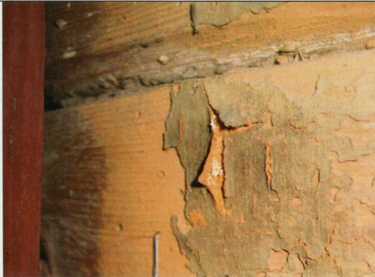
Detalj av veggen som viser lag 4 som stopper mot gerikt. Bak gerikta er det ikke maling. Legg merke til hvor gul fargen er i oppskallingen.
