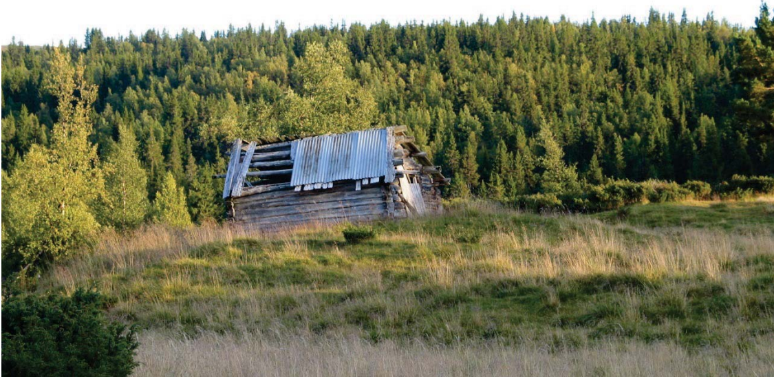
05420011054: Nest etter driftsbygninger i tunet, var det utmarks- og seterhusene som var gjennomsnittlig i dårligst forfatning i 2. omdrev. Det samme var tilfelle i 3. omdrev. På dette seterfjøset var deler av taket vekk i 2005. Foto: Kulturminnekompaniet 2005.
