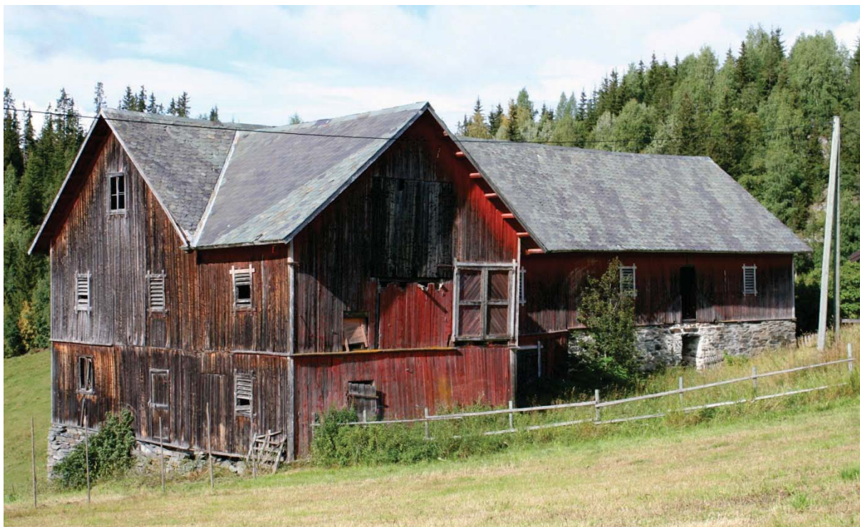
05420012060: Driftsbygningene i tunet er mest utsatt for forfall. Det samme var tilfelle både i 1. og 2. omdrev.
