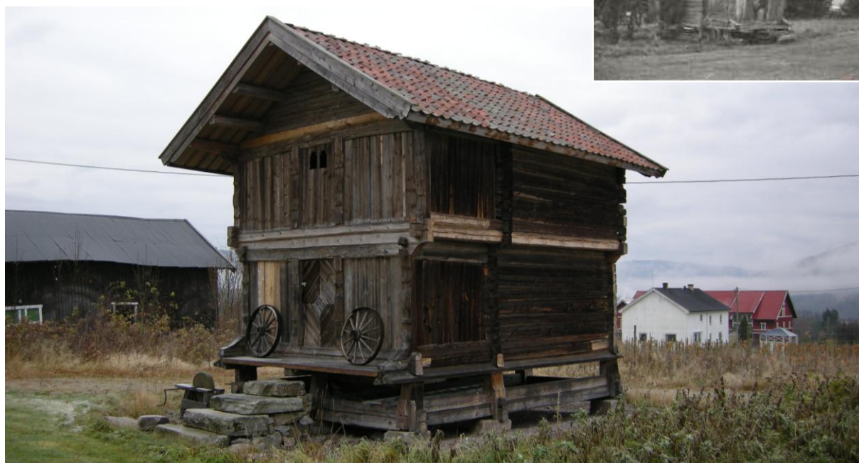
Stabburet (loftet) på Øvre Grini var angrepet av husbukk og råte ved registreringen i 1985. I 2004 var det tatt ned og inngikk derfor som tapt ved 1. omverv. Det er nå gjenoppført og restaurert. (0821-006-089)
