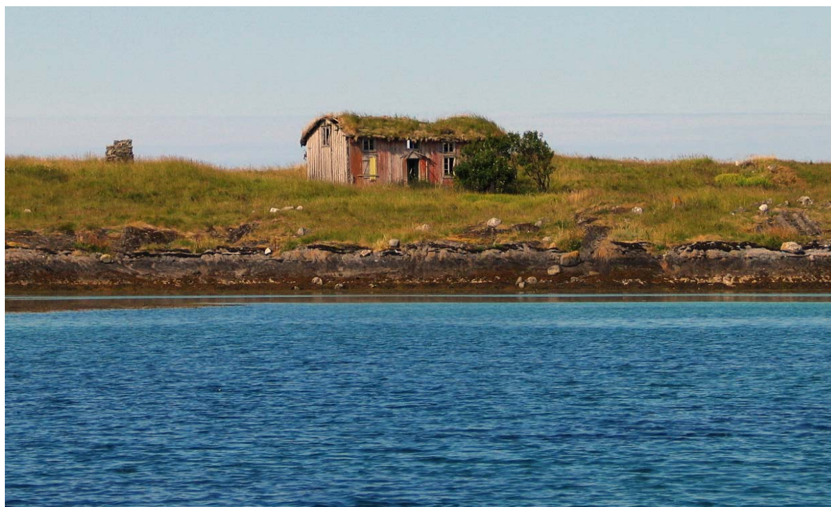
1815-0111-085. Bolighuset må betegnes å være i dårlig stand. Det står alene igjen på et for lengst fraflytta bruk på en av øyene i delområde Vegaøyen. Til venstre i bildet pipa etter eldhuset. Bolighus er den mest truede hustypen i Vega.
