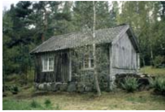
0911-106-047. Stua på husmannsplassen Toftkjenn-Øygard under Østerholt i Ytre Gjerstad er blant de mest autentiske i sitt slag, men den har ikke vært bebodd på noen år og er bl.a. truet av taklekkasje. Plassen ligger til et bevart parti av den gamle "Vestlandske Hovedveg" som går like forbi huset.
