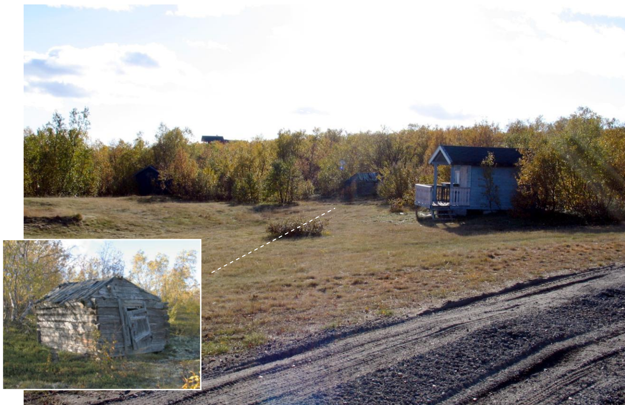
2011-004-026. Stabbur på småbruk ved Kautokeinoelva. Ved SEFRAK-registreringen i 1980 ble tilstanden betegnet å være begynnende forfall, i 2005 var den forverret. Her sto også et annet stabbur ved forrige omverv (2000), men det var borte i 2005. Det er særlig bygninger på småbruk som er i dårlig stand.
