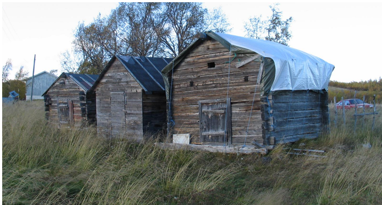
2011-004-029, 030. Stabbursrekke på bruk ved Kautokeinoelva, dannet etter SEFRAK-registreringen i 1980, dels med tilflyttete hus. Bare det nærmeste er datert til 1800-tallet og er med i undersøkelsen. Status er om lag som i 2000, men taket begynner å bli dårlig – og presenning er lagt over.
