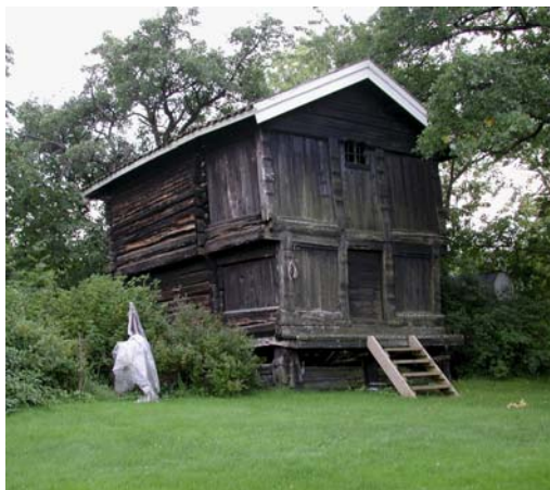
0821-006-040. Stabburet er angrepet av husbukk, som er et problem ved mange gamle hus i Bø. Det er et gammelt loft, datert til 1741, og har tradisjonell spyneskurd på hjørnestolper og beitskier.
