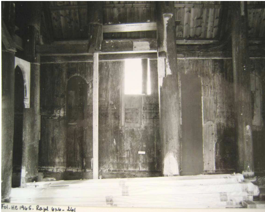
Fig. 4. Avfotografert foto i Riksantikvarens arkiv som viser interiøret i kirken under istandsettingen. Fotografiet viser den vestre delen av nordveggen i kirken.
