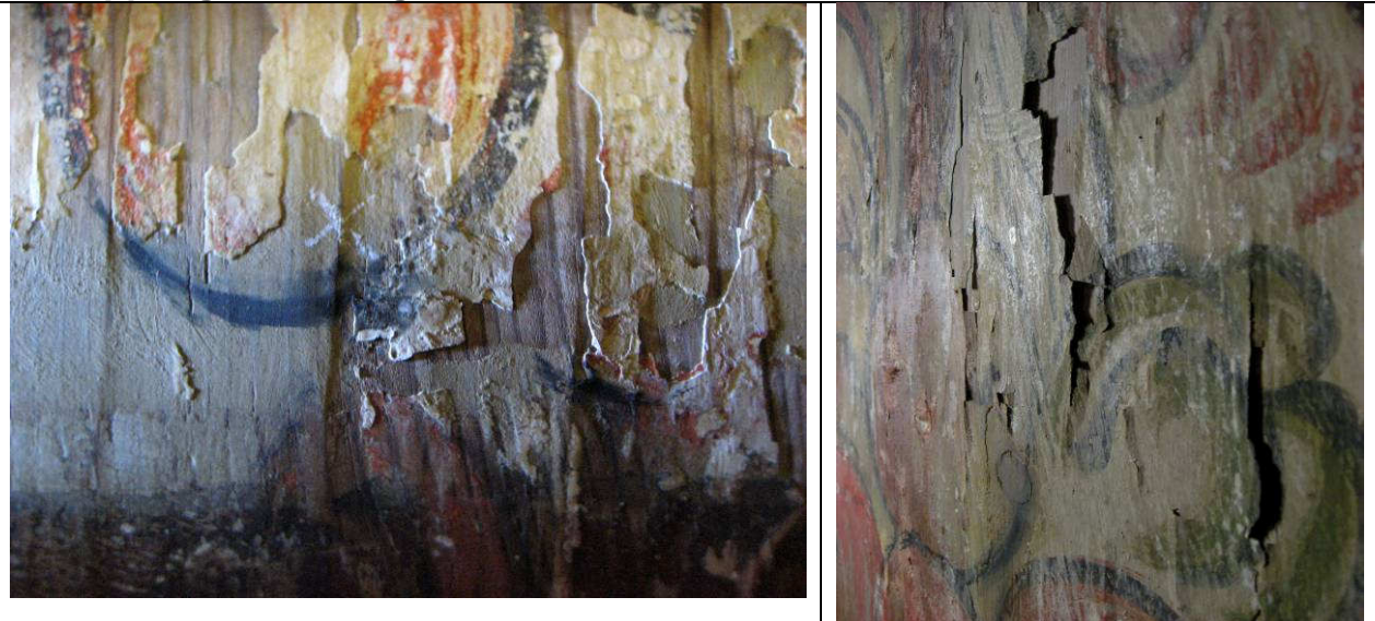
Fig. 55 og 56 viser typiske opp- og avskallinger i malingen i koret. Fig. 54, fra østre del av nordveggen, viser også del av en retusj. Fig. 56 er fra området sør for vinduet på østveggen.
