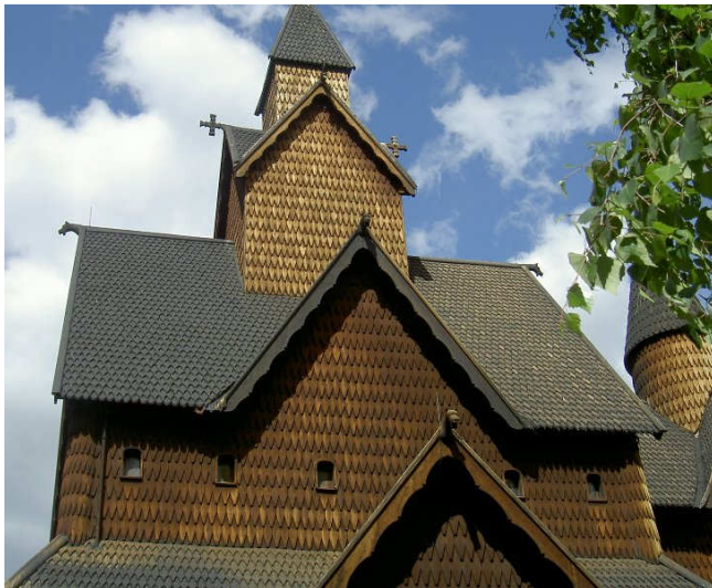
Bilde 2. Takflaten til venstre (SV) har kulltilsetning i tjæra, mens takflaten til høyre (SØ) er ren tjære. Begge flater ble tjæret samtidig og med samme innkokingsgrad (høy 60). Tjæra med kull ligger bedre på, selv om noe av fargeforskjellen nok kan tilskrives kullets pigmenterende effekt. (Foto: Mette Lehmann, juni 2006)
