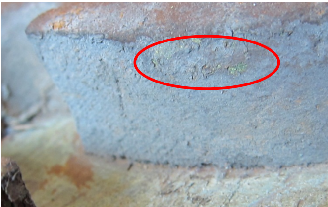
Fig. 5 Grønn farge synlig i malingtap langs nedre venstre ytterkant.
