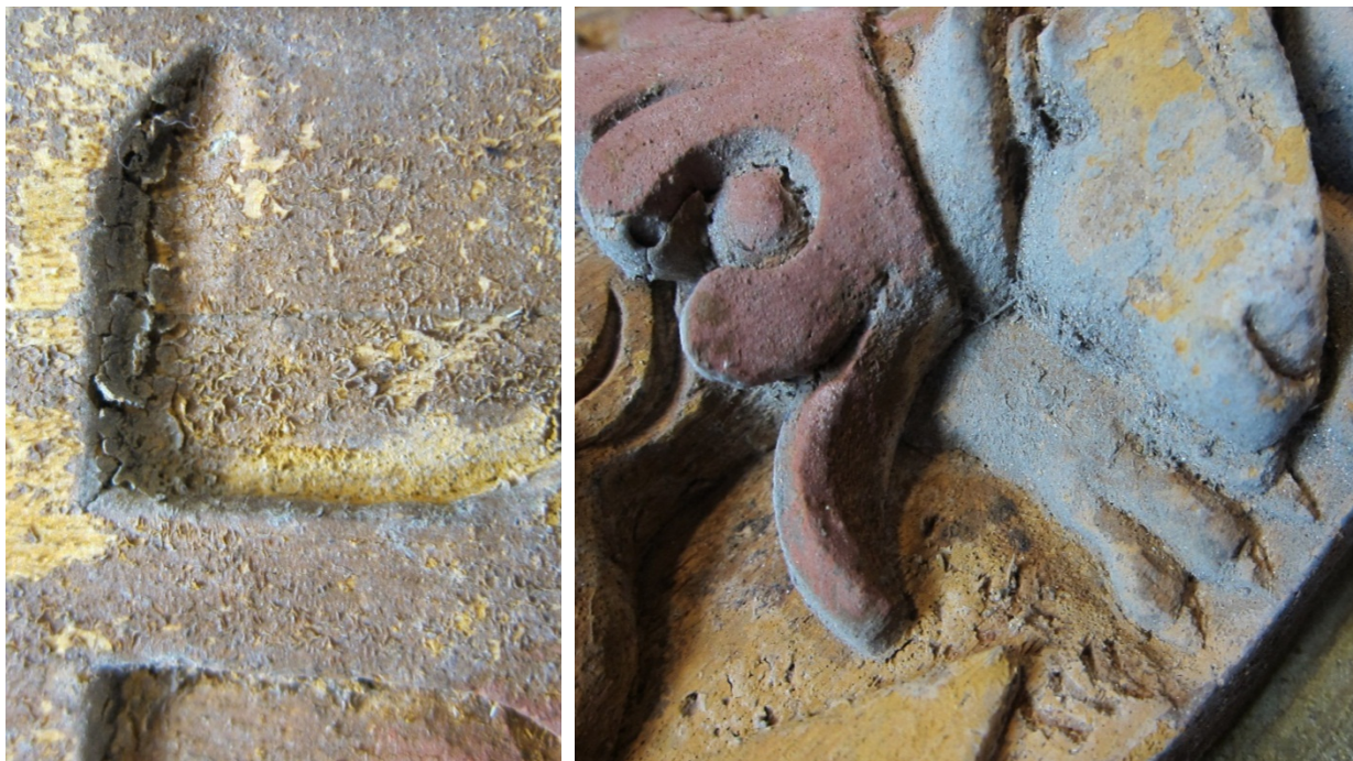
Fig. 9 Oppskallet og avskallet maling, overflatesmuss
