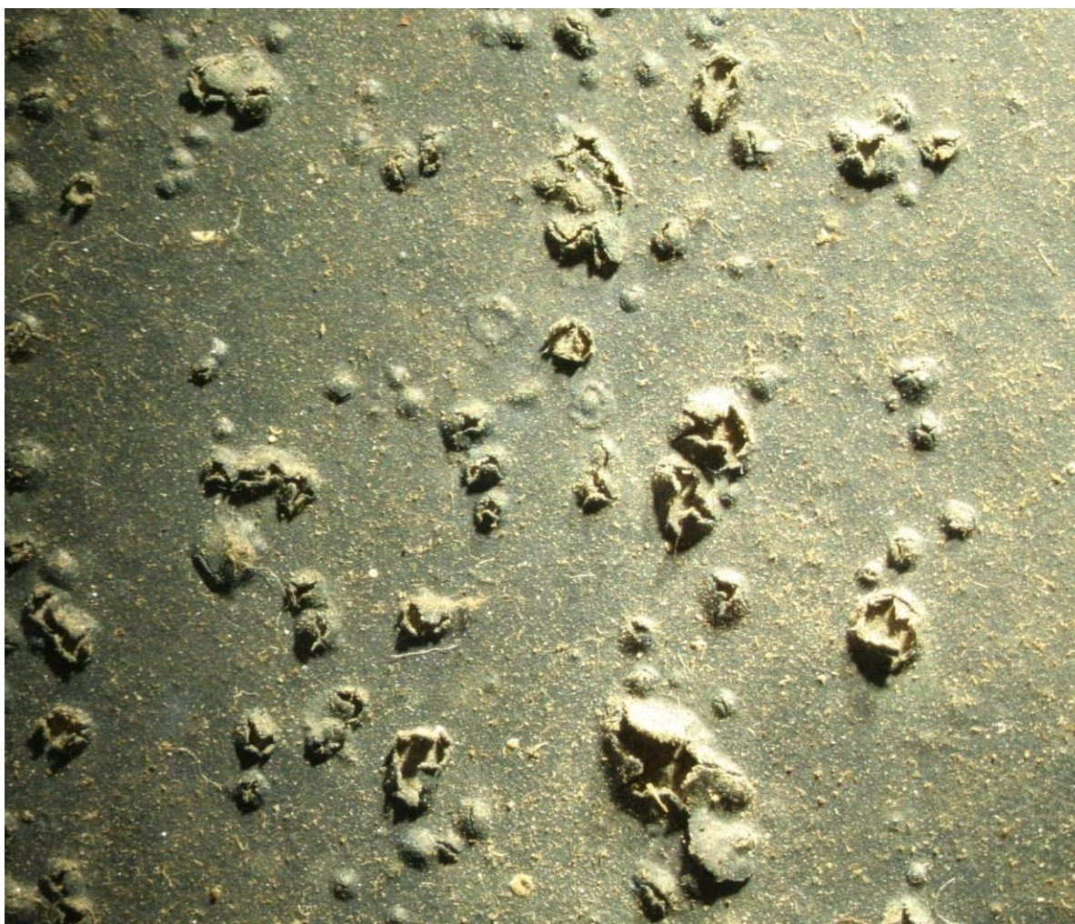
Fig.4 Detalj skjold, B, sett gjennom mikroskop. På bildet ser man små vortelignende klumper i malingen. Det kommer av at korrosjonsproduktet (tinnoksid) tar større plass enn ren tinn, og dermed presser malingen opp. Når det blir mye nok korrosjon, vil malingen sprekke, og man får kratere. Tinnoksidet, som er porøst, vil forsvinne slik at jernoverflaten blir eksponert.
