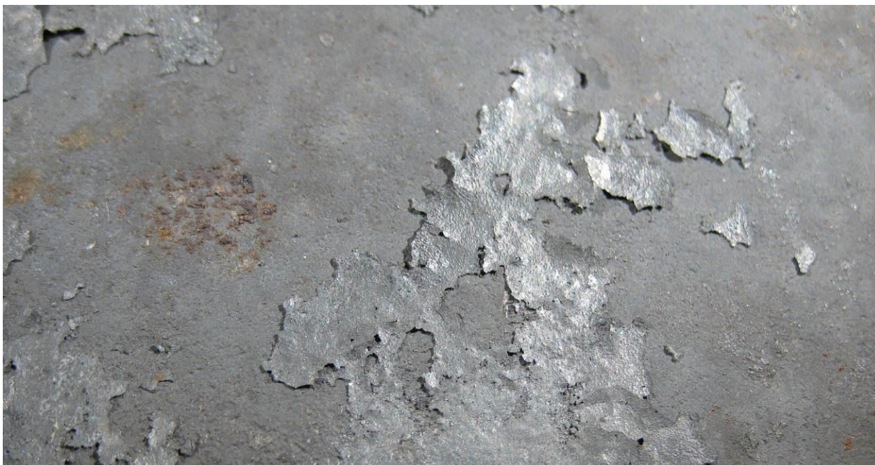
Fig 3. Detaljfoto av baksiden. Grått tinn ligger som porrøse flak over jernplaten. Til venstre i bildet sees en klynge med rustklumper.
