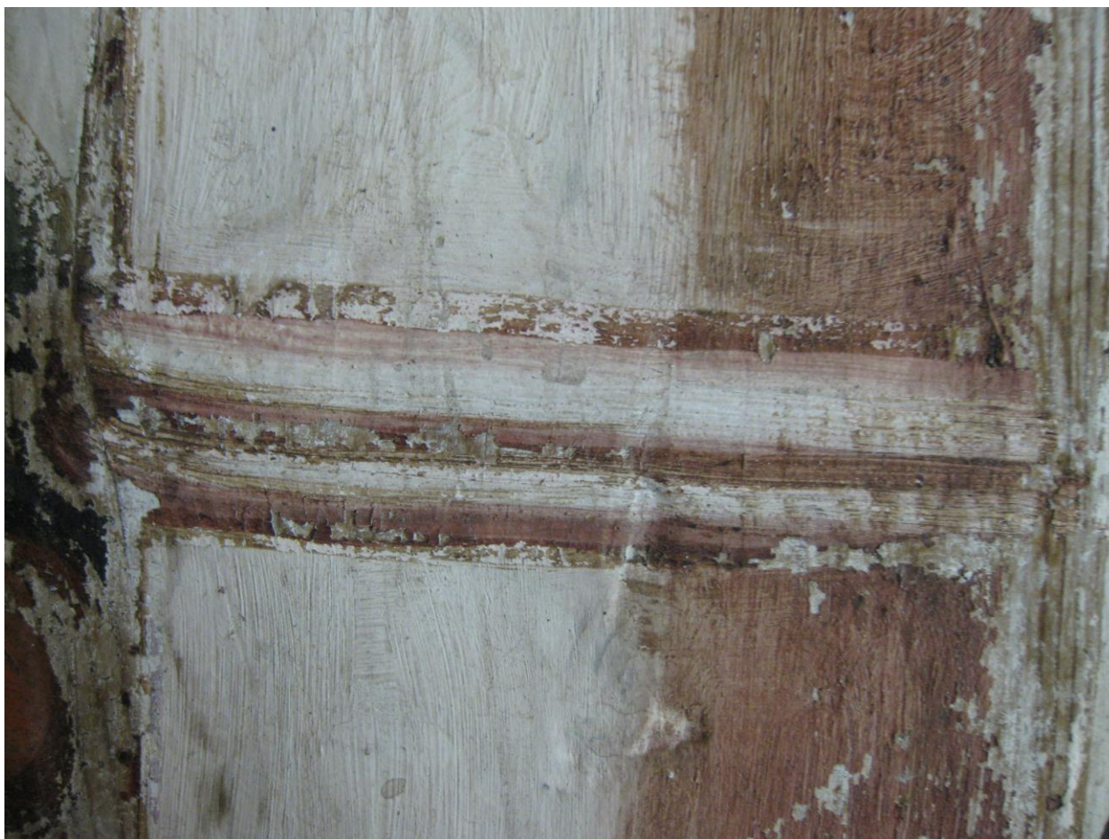
Fig. 12 Detalj av en søyle på venstre siden av skrifttavlen. Her kan man se at det er malt med to farger oppå den hvite bunnfargen. En laserende brun og en laserende rød farge. Det er omfattende oppskallinger og utfall i lasurene. Spesielt der hvor de overlapper. Den hvite bakgrunnsfargen har ikke det samme problemet.
