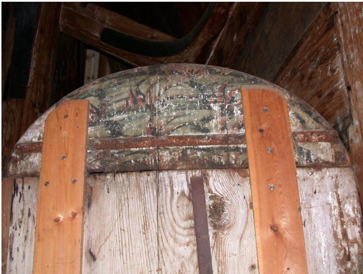
Fig.5 Vestvegg. Detalj av dør. Før behandling 2010
