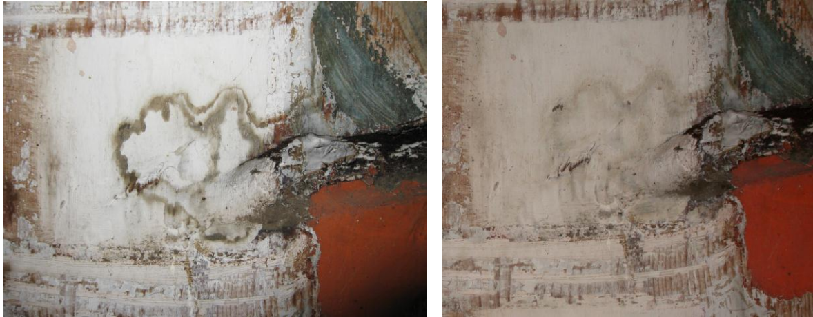
Fig. 16 og 17 Før og etter behandling av vannskjold. Detalj skriftfelt, sørvegg.
