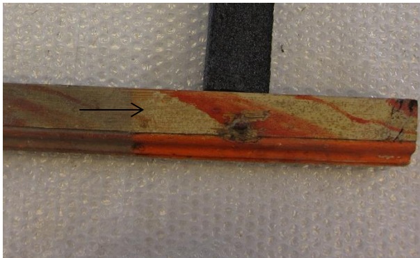
Figur 8: Brystninglist under rensingen. Pilene viser et område som er renset med rensigel (Pemulen®) og melamin-rensesvamp.
