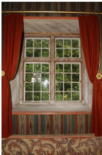
Figur 11. Vinduskarmer, vindusmyg og vindusgerikter er opprinnelige. Vindusrammene er skiftet, trolig i 1770- årene. Karmer, smyg og gerikter har marmorering utført i oljebasert maling. Maling og dekor er svært nedbrutt, avslitt og delvis overmalt.
