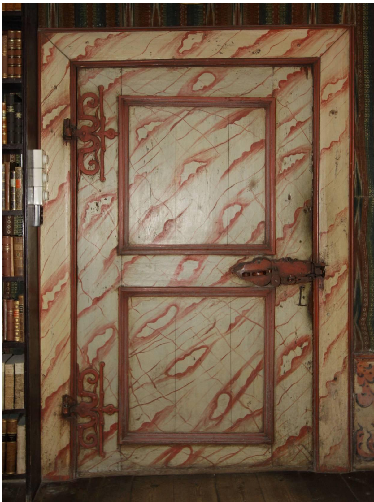
Figur 8. Dør 206/201. Begge dørene i rommet med hengsler og beslag er opprinnelige fra 1665. Dørene er malt og dekorert med oljebasert maling i en fantasimarmor. Dekoren er skitten og har skader etter overmaling som tidligere er fjernet.
