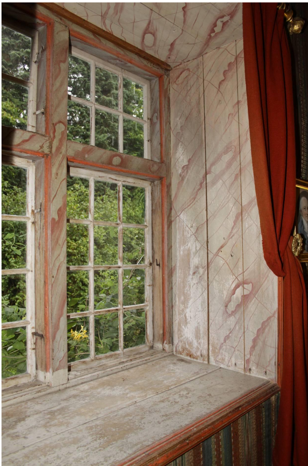
Figur 13. Nordøstre vindu. Mekanisk slitasje, nedbrutt- og manglende maling er lett synlig.
