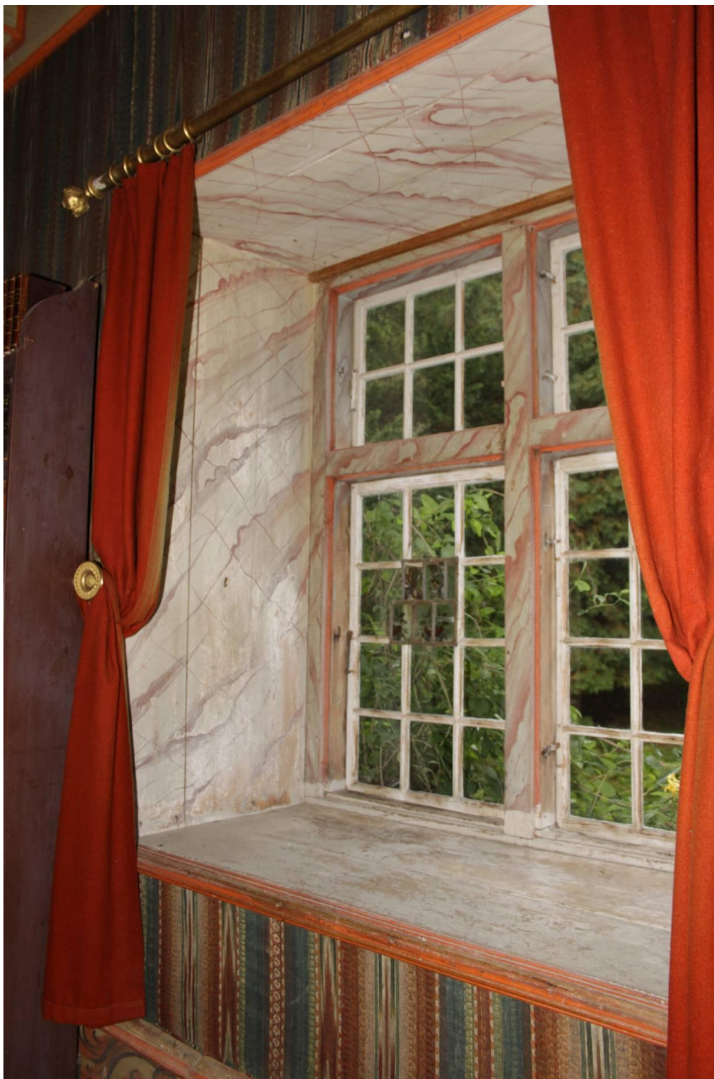
Figur 14. Nordøstre vindu. Mekanisk slitasje, nedbrutt- og manglende maling er lett synlig.
