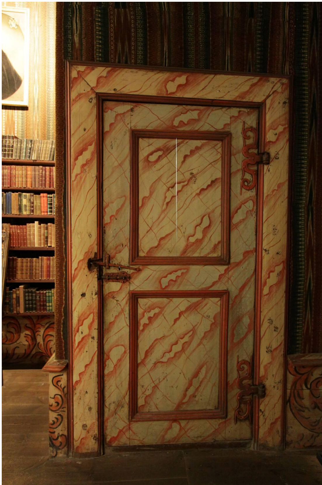
Figur 7. Dør 206/205. Begge dørene i rommet med hengsler og beslag er opprinnelige fra 1665. Dørene er malt og dekorert med oljebasert maling i en fantasimarmor. Maling og dekor er samtidig med tapetene. Dekoren er skitten og har skader etter overmaling som tidligere er fjernet.
