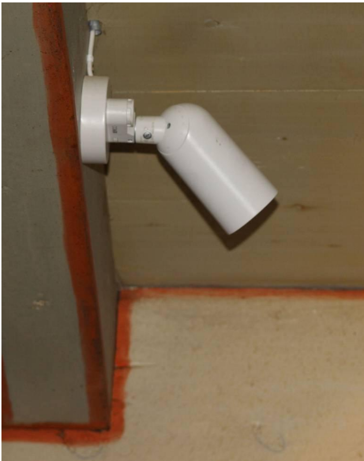
Figur 24. Det er installert flere spotlamper i rommet. Spotlyset er rettet mot portrettene som henger i rommet. Lyssettingen brukes i forbindelse med omvisningene i rommet. Alle disse lampene utvikler sterk varme. Varmeutviklingen kan medføre risiko for brann. Varmen fra lampene akselererer nedbrytingen av alle malte og umalte flater i nærheten av lyskildene. Lyset vil også forsterke nedbrytingen av tekstilene der lyset treffer disse.
