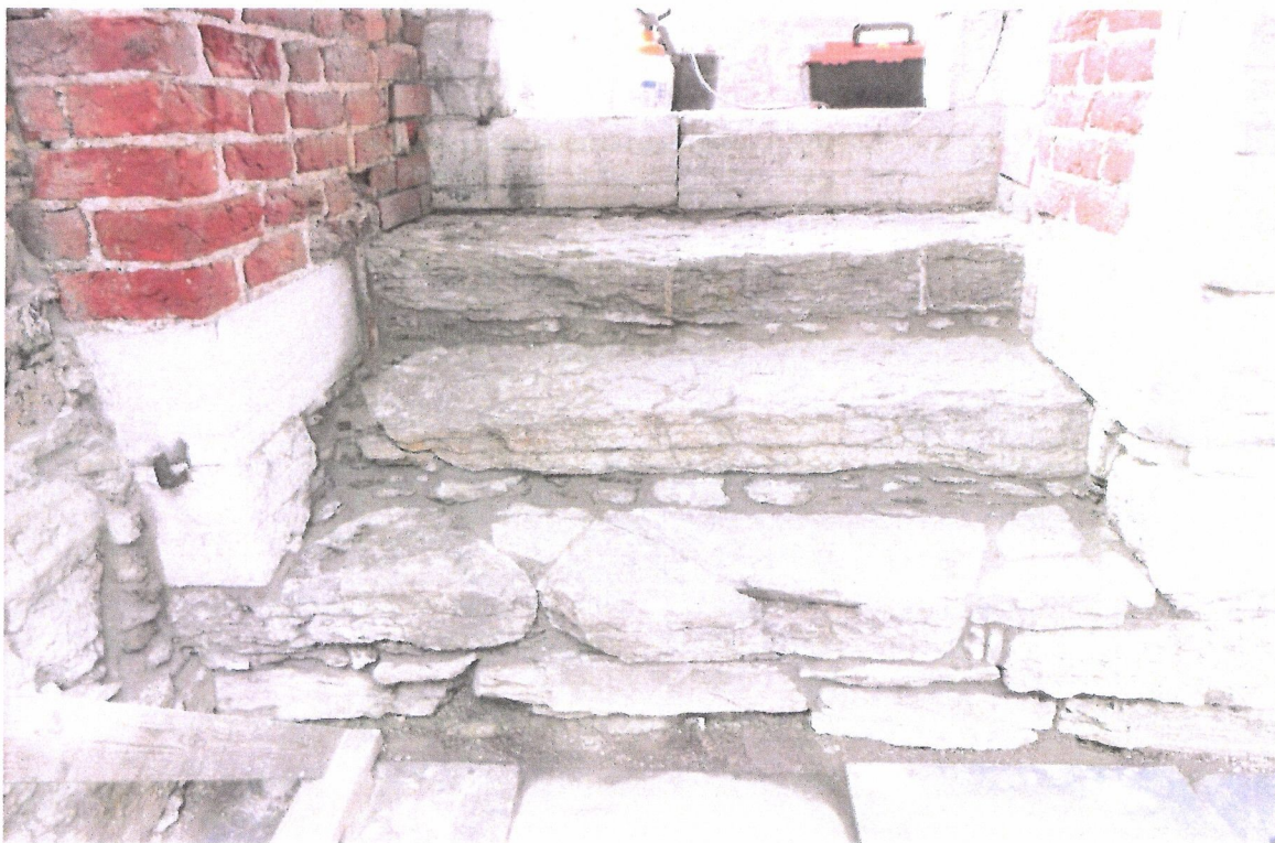
Trappa med de limte hellene på plass og nye pinnede fuger mellom trinnene
